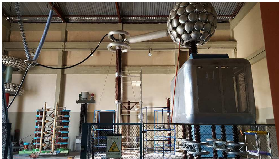
Figura 1 – Salão de Alta Tensão.
