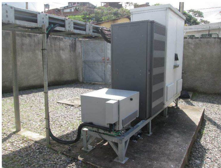
Figura 17 - Gabinete FCOB com System Module instalado no site SLJGCR07, Jaboatão dos Guararapes/PE (Fonte: SAVENGE Engenharia LTDA)
