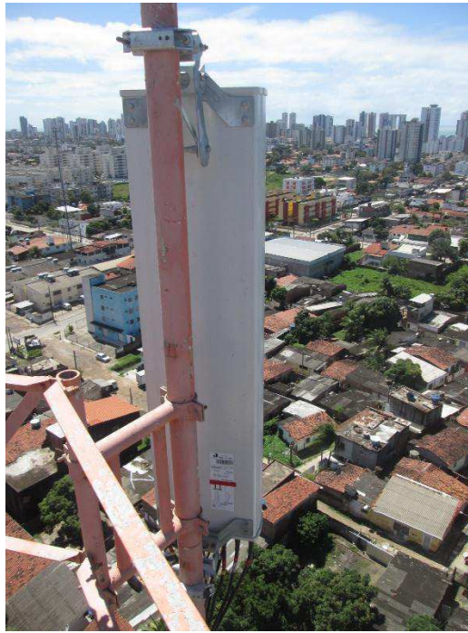
Figura 18 - Antena Kathrein 80010767 instalada no site SLJGCR07, Jaguaribara/CE (Fonte: SAVENGE Engenharia LTDA)
