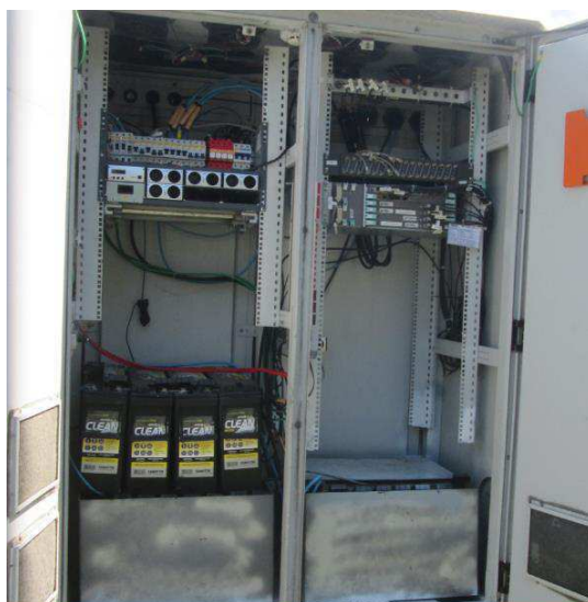
Figura 9 - Gabinete OPSS aberto para mostrar o sistema de energia CC: régua de disjuntores, unidades retificadoras e baterias (Fonte: SAVENGE Engenharia LTDA)
