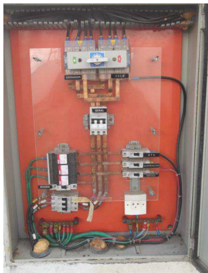
Figura 8 - Quadro de distribuição de corrente alternada (Fonte: SAVENGE Engenharia LTDA)
