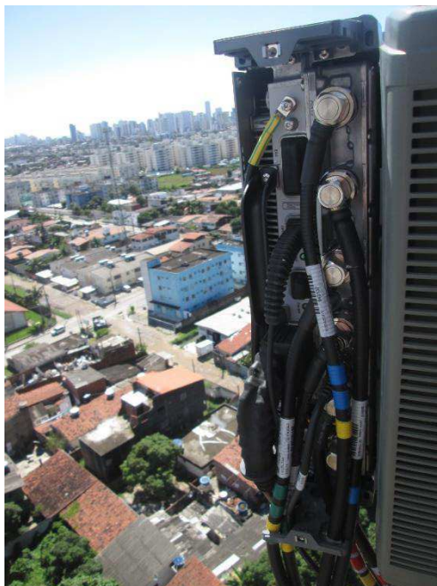
Figura 16 - Módulo de RF instalado no site SLJGCR07, Jaboatão dos Guararapes/PE (Fonte: SAVENGE Engenharia LTDA)
