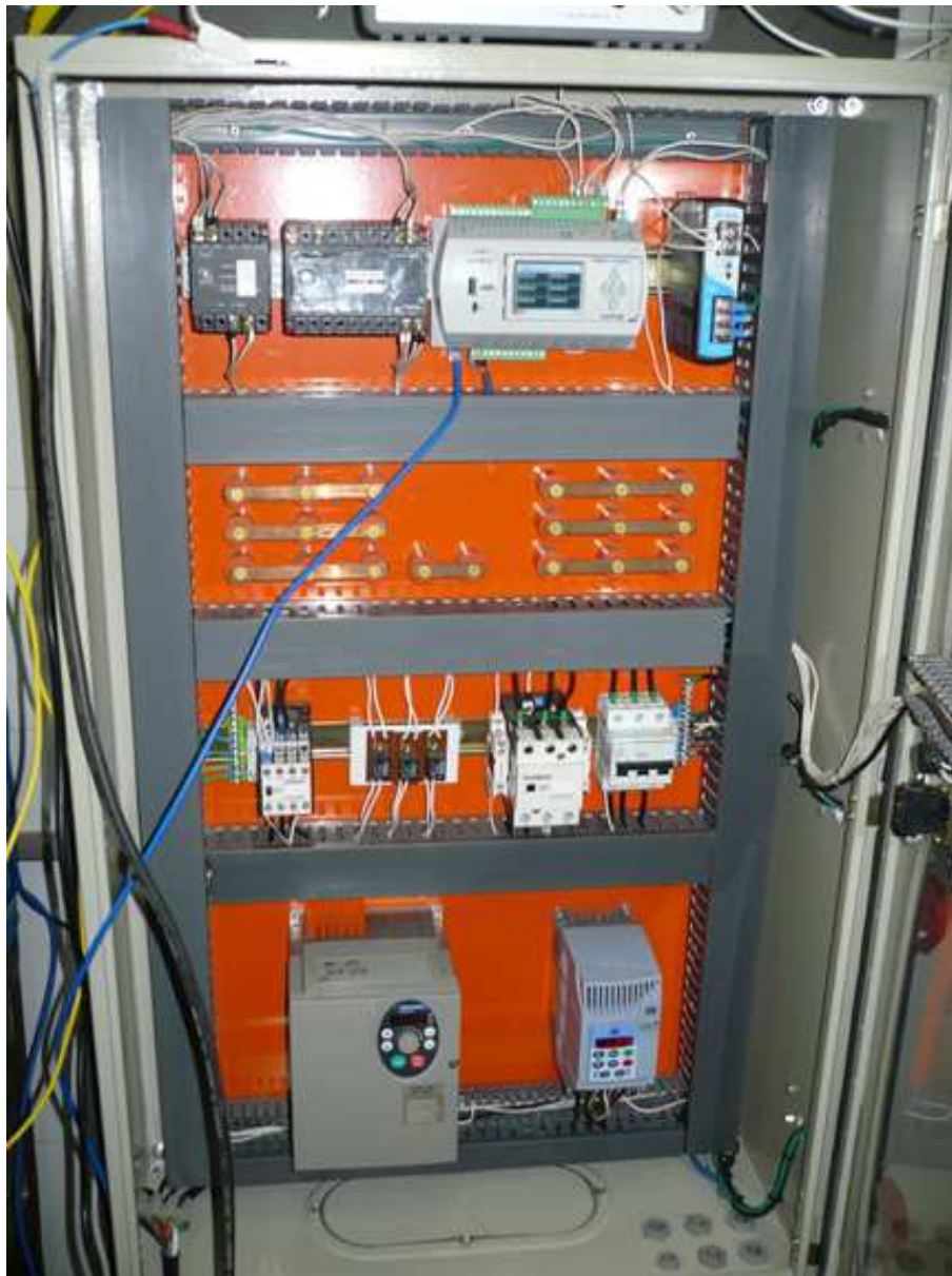
Figura 4.2: Fotografia do quadro elétrico do circuito hidrotérmico com dois inversores e um DataLogger
