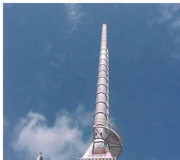
Figura 2.5: Chaminé da Fornalha.
