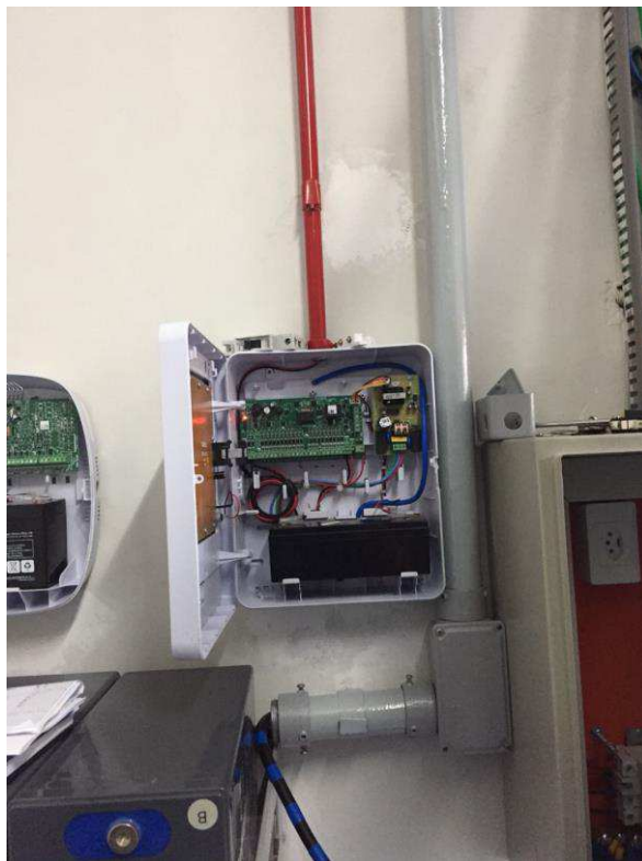
Figura 11: Central de incêndio.
