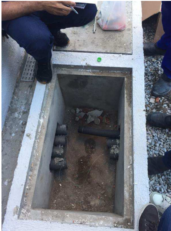
Figura 12: Caixa de passagem da rede óptica e da rede elétrica
