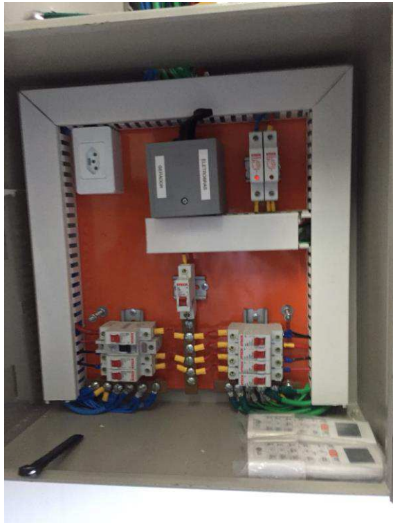
Figura 10: QDCA – Parte elétrica
