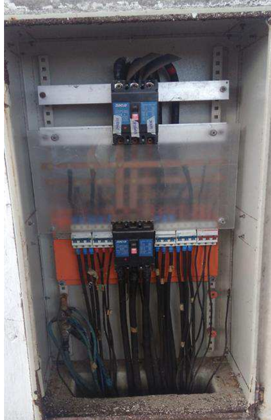
Figura 10- Quadro de distribuição que recebe os cabos provenientes da subestação
