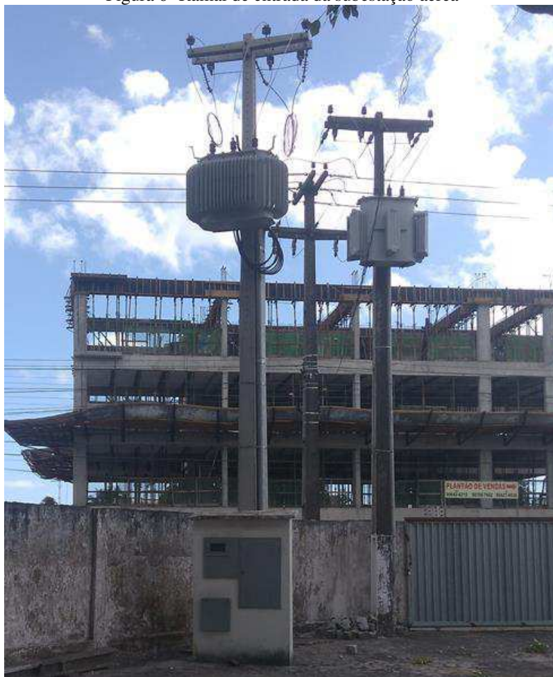
Figura 6- Ramal de entrada da subestação aérea
