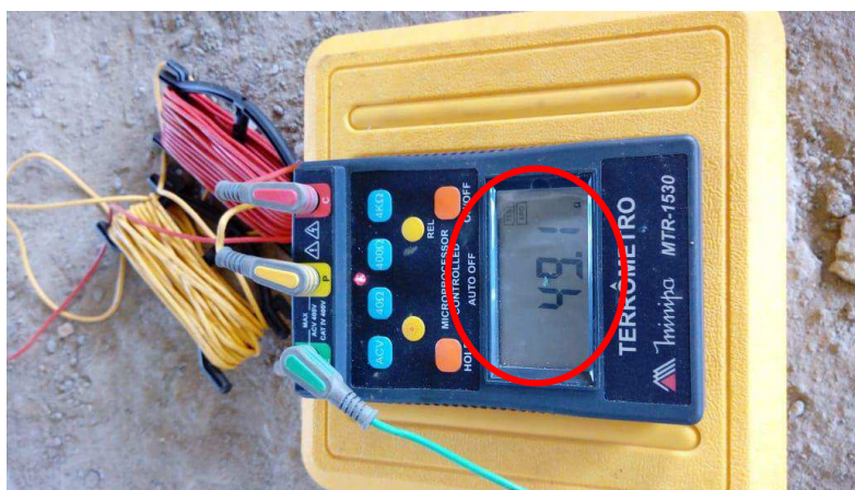
Figura 12: Resistência da malha de aterramento.
