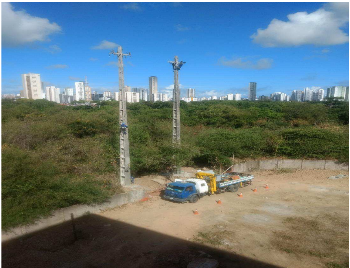
Figura 22: Detalhe da montagem eletromecânica
