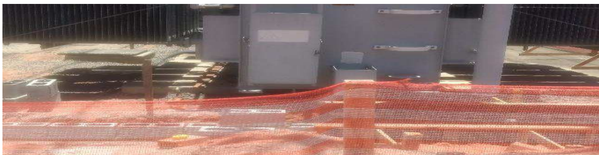
Figura 10: Aspectos de segurança e sinalização na SE OLINDA (b)
