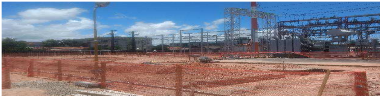
Figura 9: Aspectos de segurança e sinalização na SE OLINDA (a)
