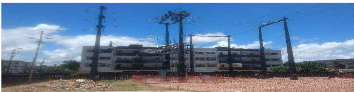
Figura 11: Aspectos de segurança e sinalização na SE OLINDA (c)
