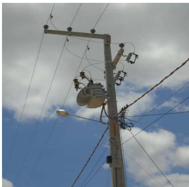
Figura 12 – Poste com Transformador e Chaves-Fusível – Referência para Croqui.
