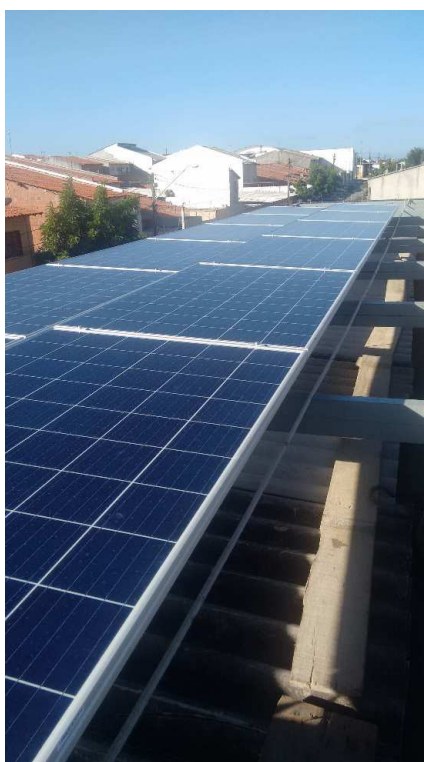
Figura 21 – Sistema Solar Fotovoltaico da Sevel Engenharia.
