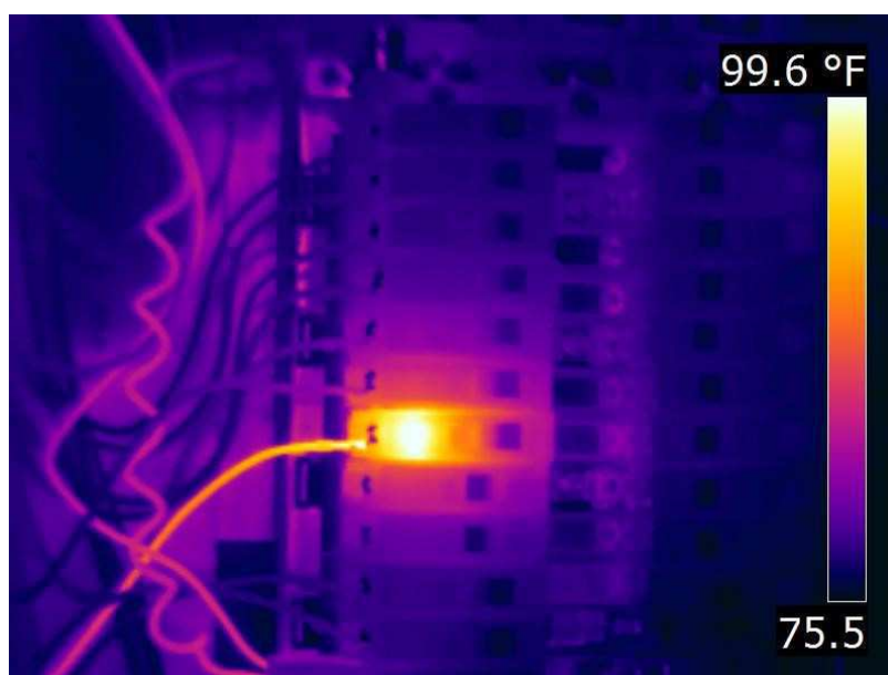
Figura 2 – Imagem termográfica de um quadro elétrico.
