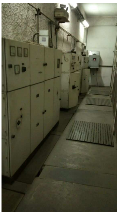
Figura 3 – Subestação 1 - quadros elétricos.
