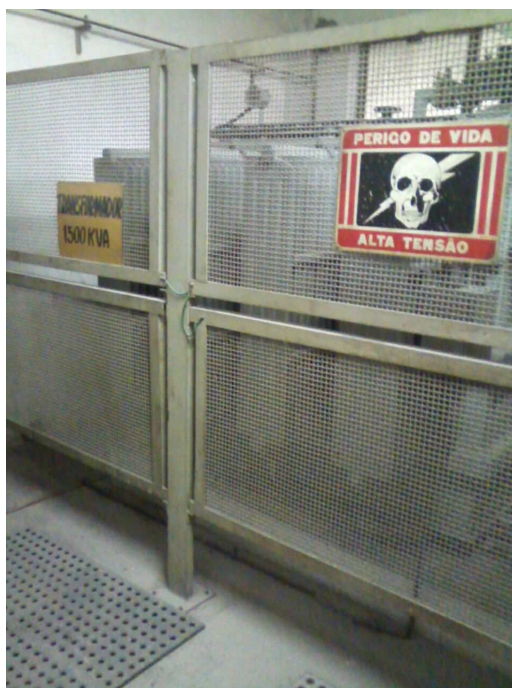
Figura 6 – Subestação 2 - transformador de 1500 kVA.
