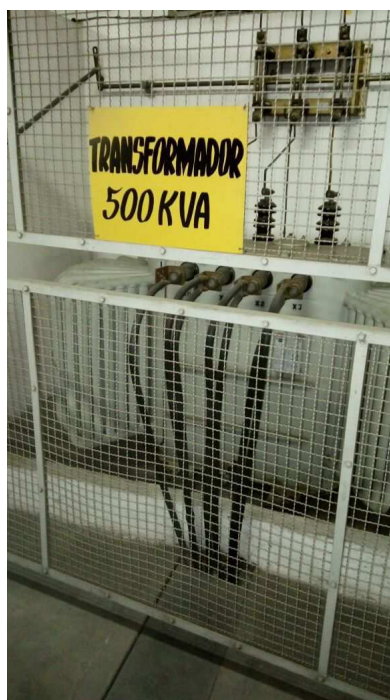
Figura 4 – Subestação 1 - transformador de 500 kVA.
