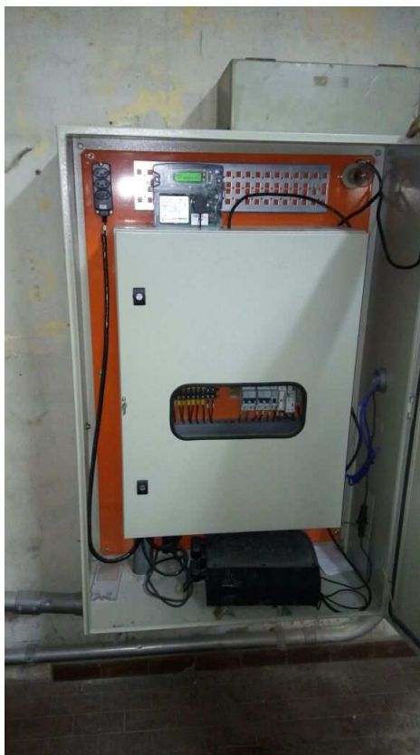
Figura 7 – Subestação 2 - quadro elétrico.
