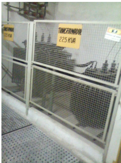
Figura 5 – Subestação 2 - transformadores de 225 kVA.
