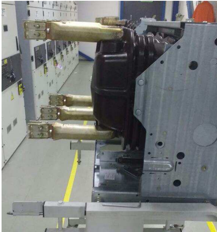
Figura 16 - Disjuntor da máquina 12 removido.
