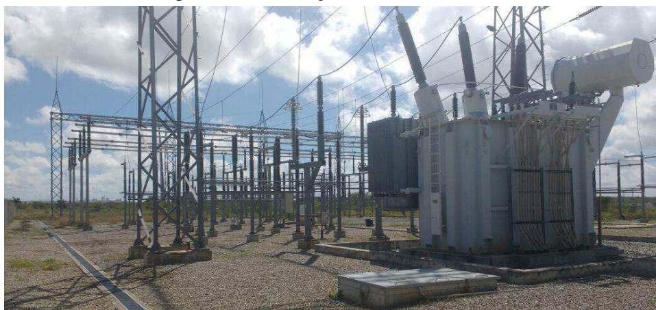
Figura 7 - Subestação 230 kV na BESA.
