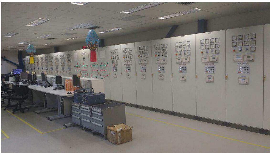
Figura 3 - Sala de Controle da BESA.
