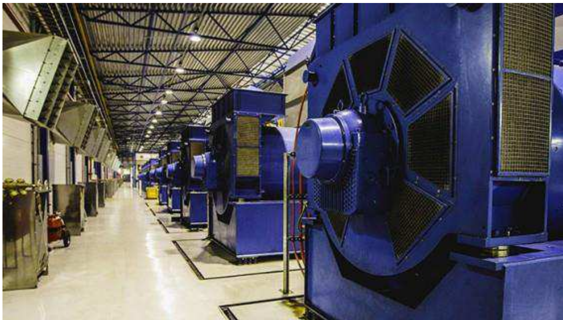
Figura 5 - Sala de Máquinas da BESA.
