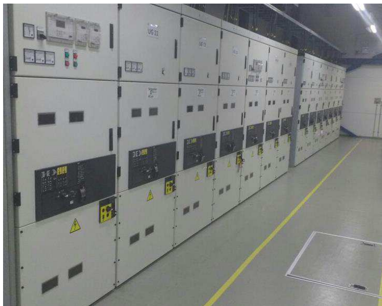
Figura 6 - Painéis da Sala de Média Tensão.
