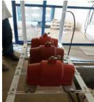
Figura 36 - Fotografia dos transformadores de potencial.
