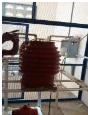
Figura 37 - Fotografia dos transformadores de corrente.
