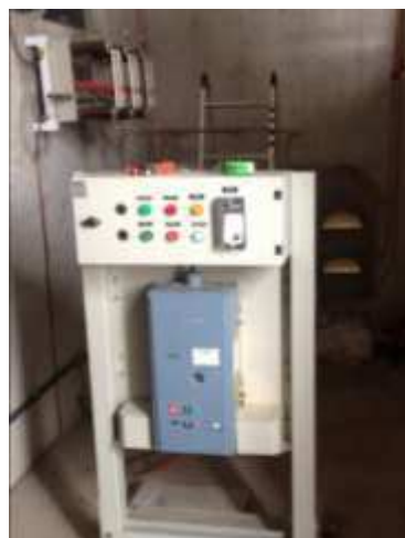
Figura 32 - Fotografia do disjuntor com relé de proteção acoplado.
