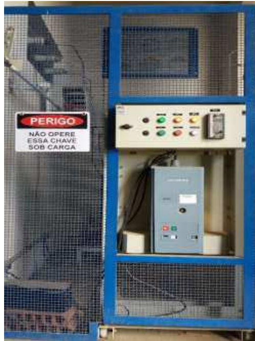
Figura 42 - Fotografia de placa indicando para não operar a chave sob carga.
