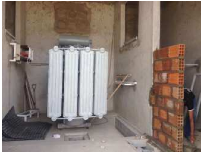
Figura 29 - Fotografia do cubículo de transformação redimensionado.
