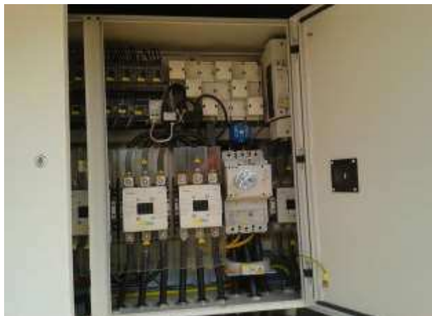
Figura 9 - Fotografia do armário distribuição do MCO11.
