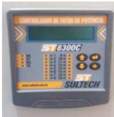
Figura 33 - Fotografia do controlador de fator de potência.
