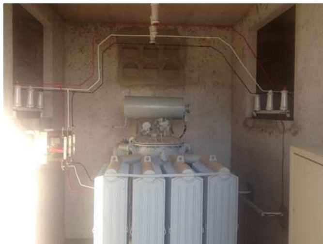
Figura 30 - Fotografia do barramento com a nova configuração.
