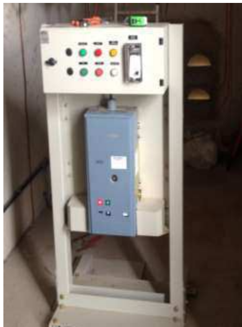
Figura 17 - Fotografia de um disjuntor de média tensão.
