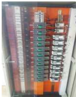
Figura 34 - Fotografia do quadro do banco de capacitores.
