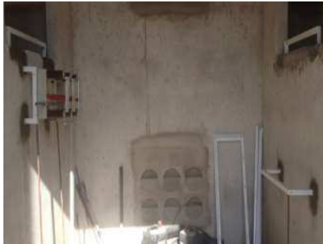
Figura 31 - Fotografia da chave seccionadora no suporte.
