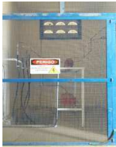
Figura 41 - Fotografia da placa alertando cubículo energizado.
