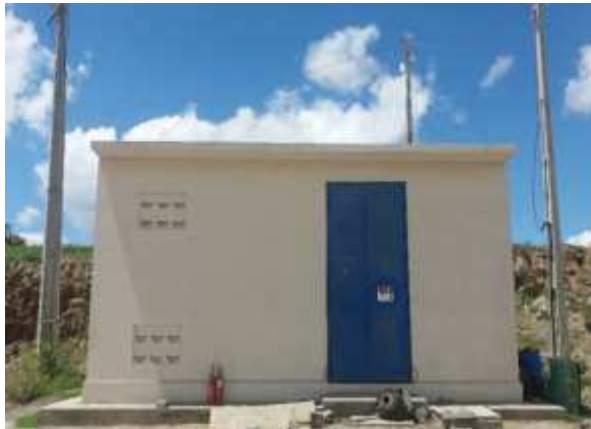
Figura 39 - Fotografia da subestação abrigada já em funcionamento.
