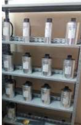
Figura 35 - Fotografia do banco de capacitores.
