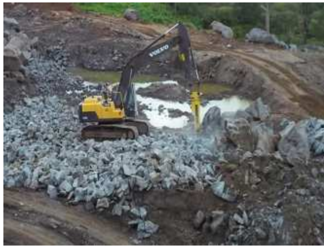
Figura 3 - Fotografia de rompedor hidráulico utilizado para redimensionamento de blocos com granulometria inapropriada para o britador.
