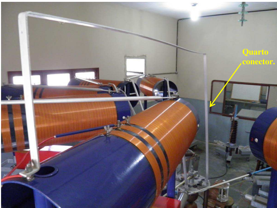
Figura 14 – Conexão do quarto conector.
