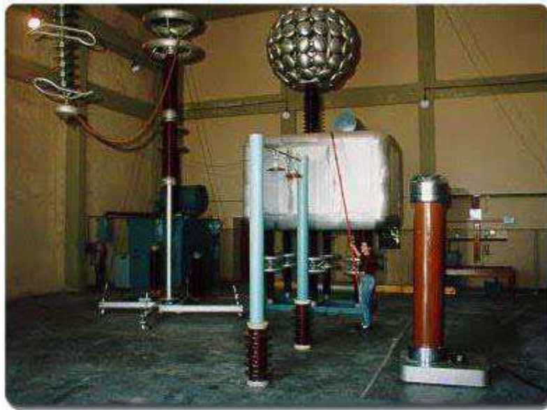
Figura 1 – Salão de alta Tensão
