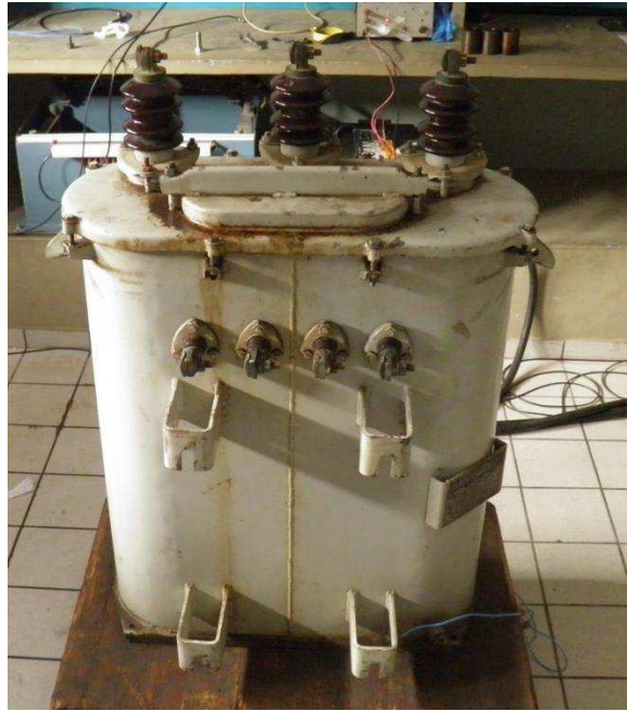
Figura 34 – Transformador utilizado nos experimentos.
