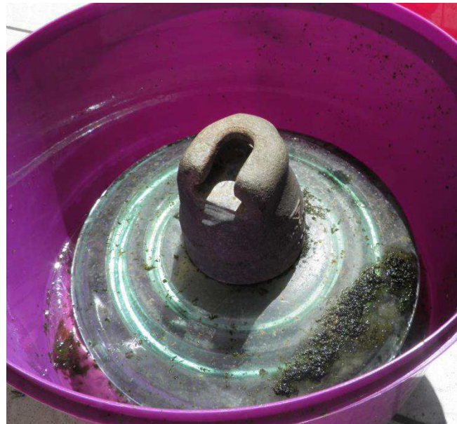
Figura 23 – Isolador com limo.
