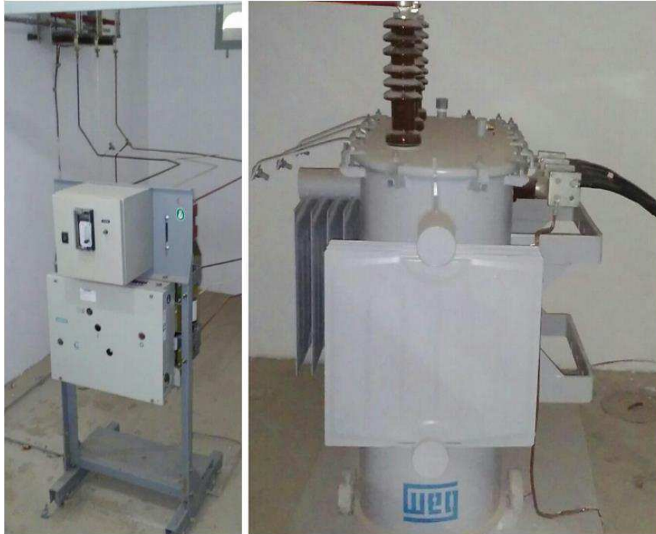
Figura 7 – Cubículo de disjunção e cubículo do transformador.
