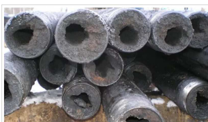
Figura 154 – Dutos com parafinas incrustadas.
