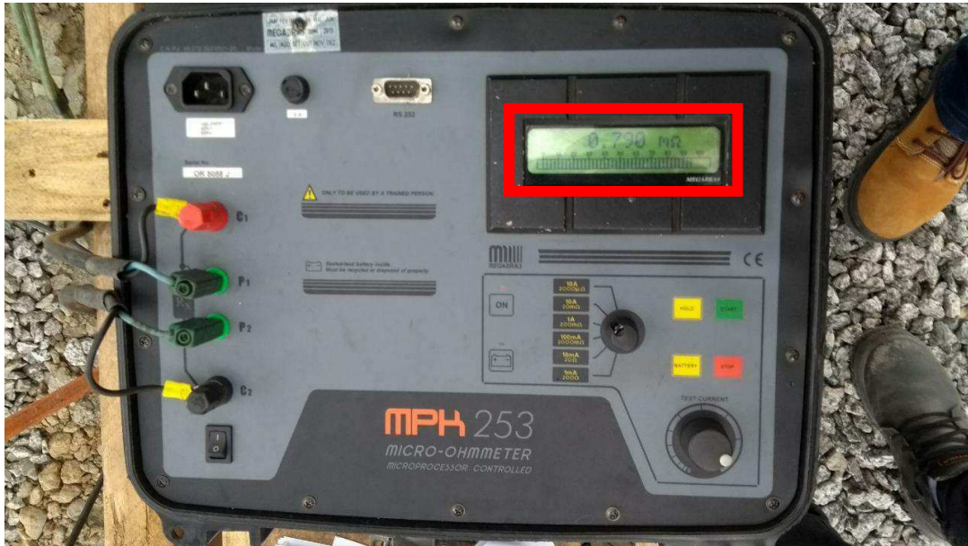
Figura 2 - Medidor de Resistência de Contato Mostrando a Resistência Medida
