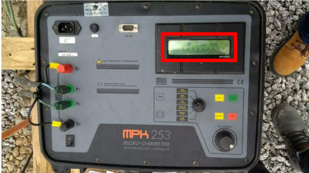
Figura 2 - Medidor de Resistência de Contato Mostrando a Resistência Medida
