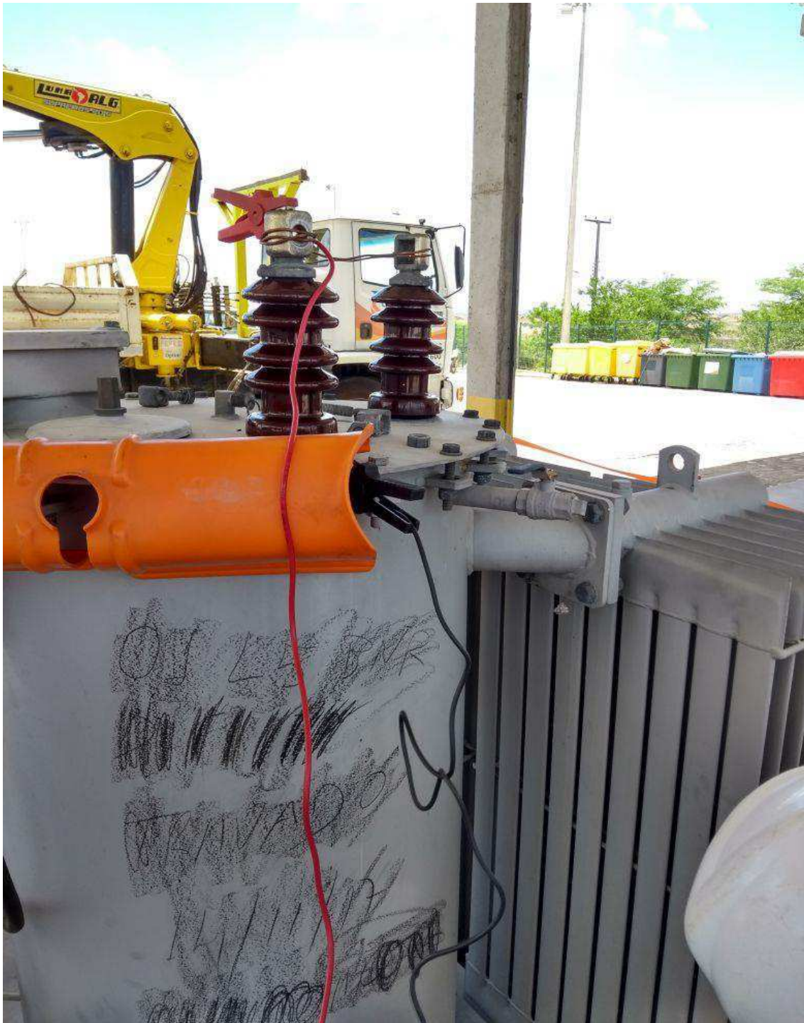
Figura 2 - Foto das Ligações dos Terminais Do RT
