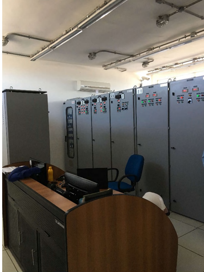
Figura 13: Centro de Controle da SE-E1
