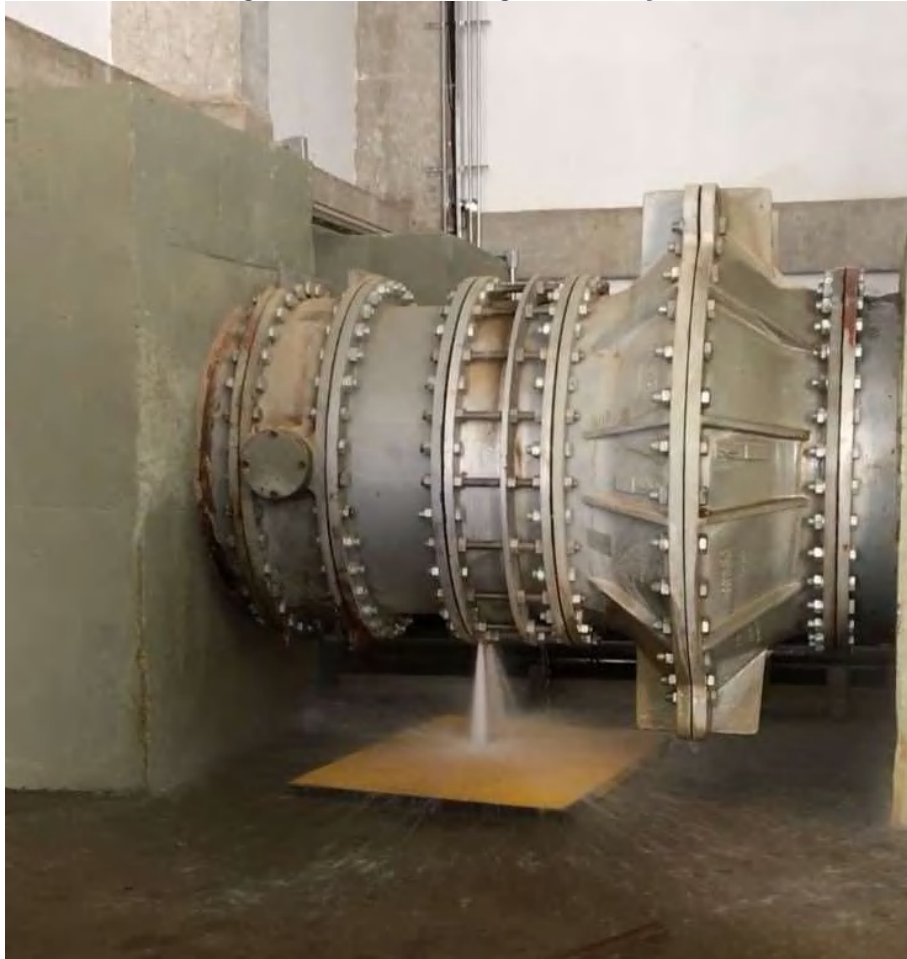
Figura 4: Vazamento de água na tubulação da EBV-4
