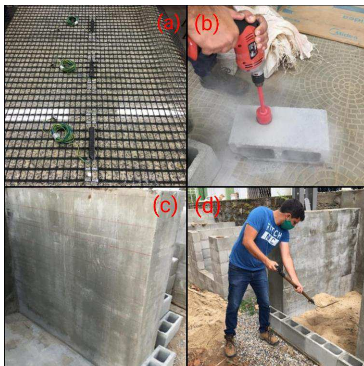
Figura 45 - (a) - Fixação dos sensores na camada de geossintético; (b) - Furo no bloco de concreto para passagem da fiação dos sensores pela face; (c) - Marcação da altura de execução das camadas a cada 15 cm de altura; (d) - Lançamento do material de enchimento
