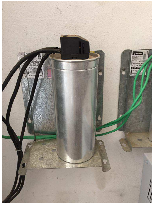
Figura 2- Banco de capacitor 30Kvar.
