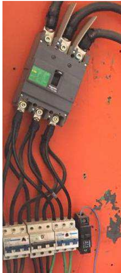
Figura 4- Disjuntores de Proteção dos Bancos de Capacitor.
