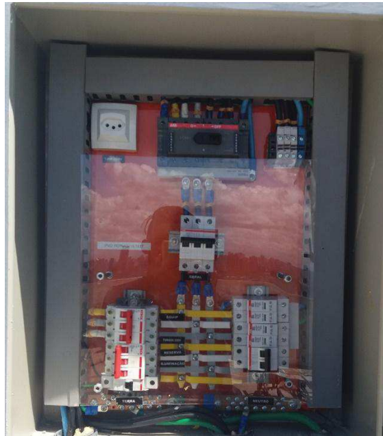
Figura 2 – Quadro de Distribuição AC do site 18PEPNA0219.
