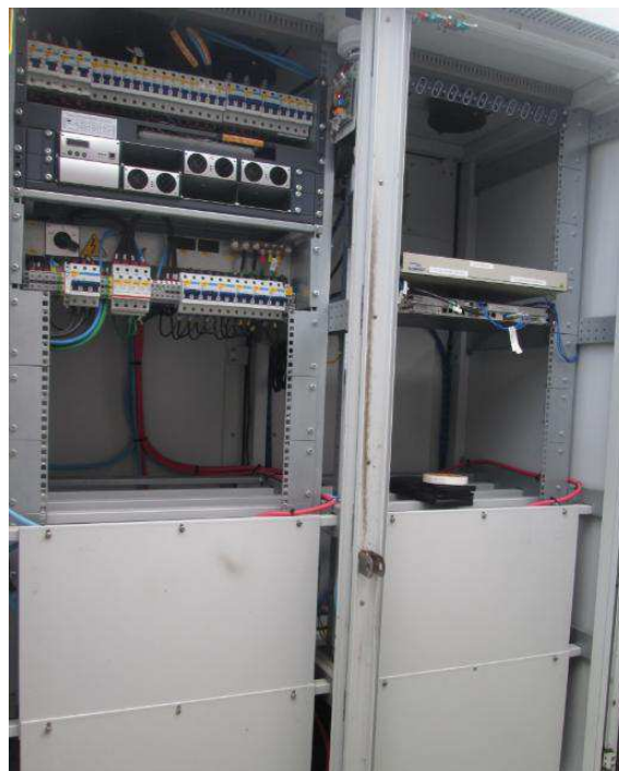
Figura 3 – Gabinete OPSS, contendo o sistema de energia DC.
