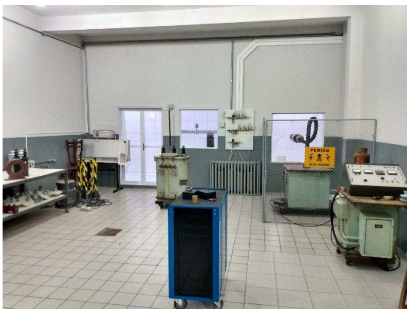
Figura 6 - Sala da Câmara de Névoa.
