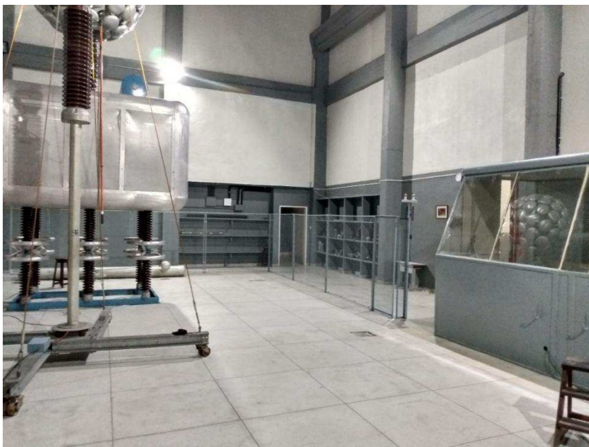
Figura 2 - Salão de Alta Tensão do LAT.
