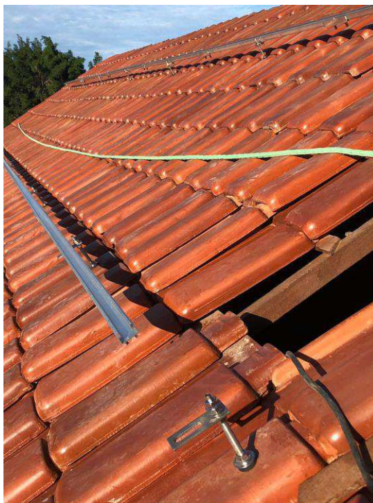
Figura 7 – Estruturas de fixação.
