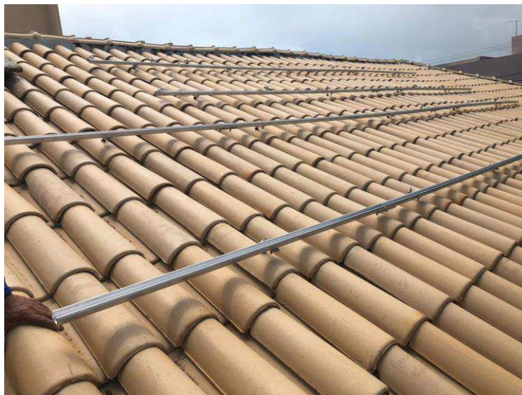
Figura 12 – Estruturas de fixação.
