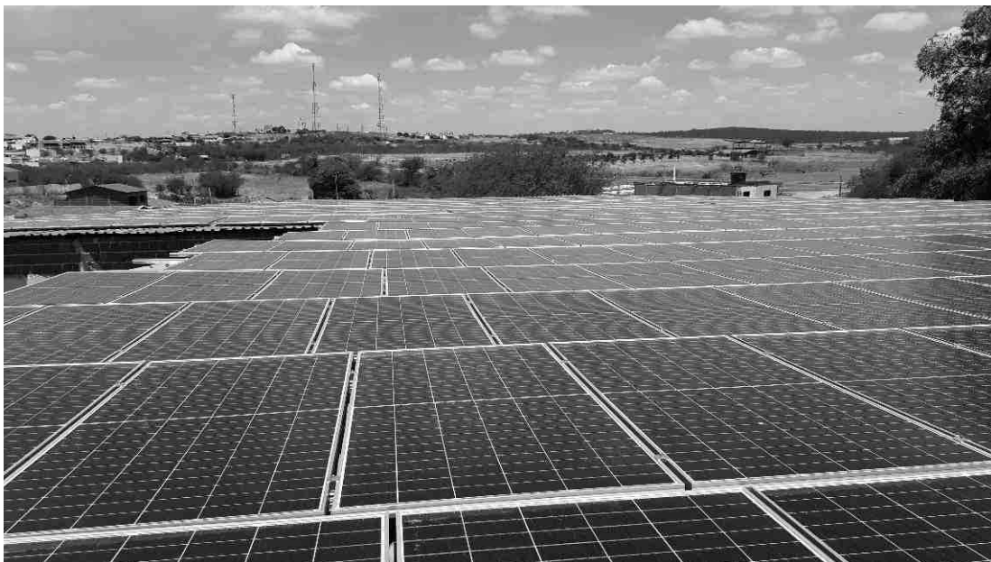
Figura 3.27 – Módulos fotovoltaicos instalados no telhado metálico.
