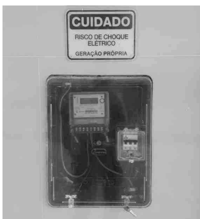
Figura 2.11 – Caixa de medição com o medidor bidirecional.
