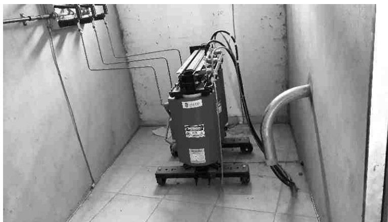
Figura 3.20 – Transformador a seco de 112,5 kVA.
