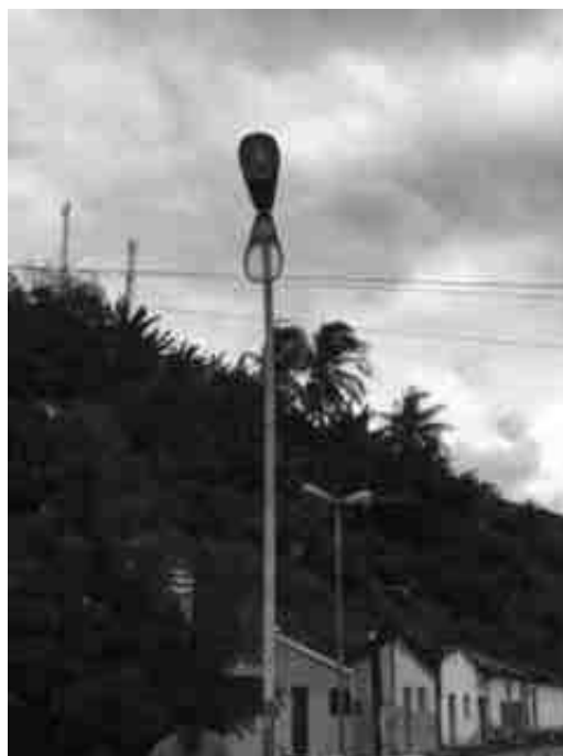
Figura 3.13 – Poste com a luminária tipo pétala na ponte saída para Areia-PB.
