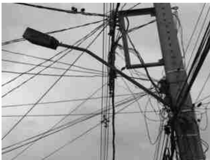
Figura 3.8 – Tipo de braço de um poste na rua 7 de Setembro.
