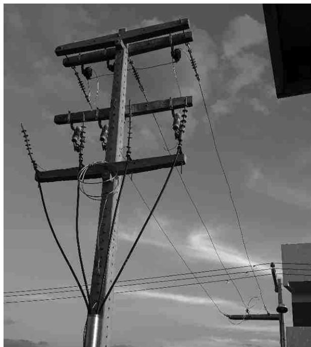
Figura 3.23 – Muflas externas instaladas.
