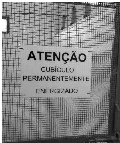
Figura 3.31 – Cubículo de medição com placas de advertência.
