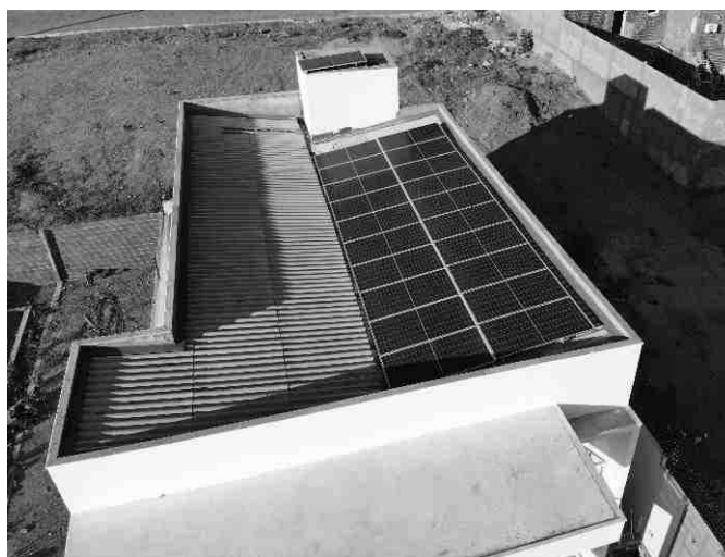
Figura 3.2 – 21 módulos fotovoltaicos instalados no telhado.
