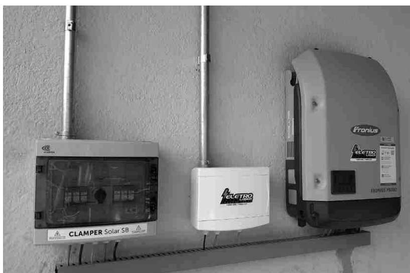
Figura 3.3 – Inversor Fronius de 6.0 kW instalado com os quadros de proteção elétrica.
