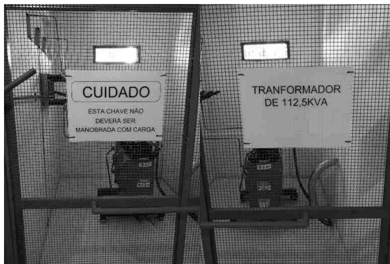
Figura 3.32 – Transformador a seco de 112,5 kVA com placas de advertência.
