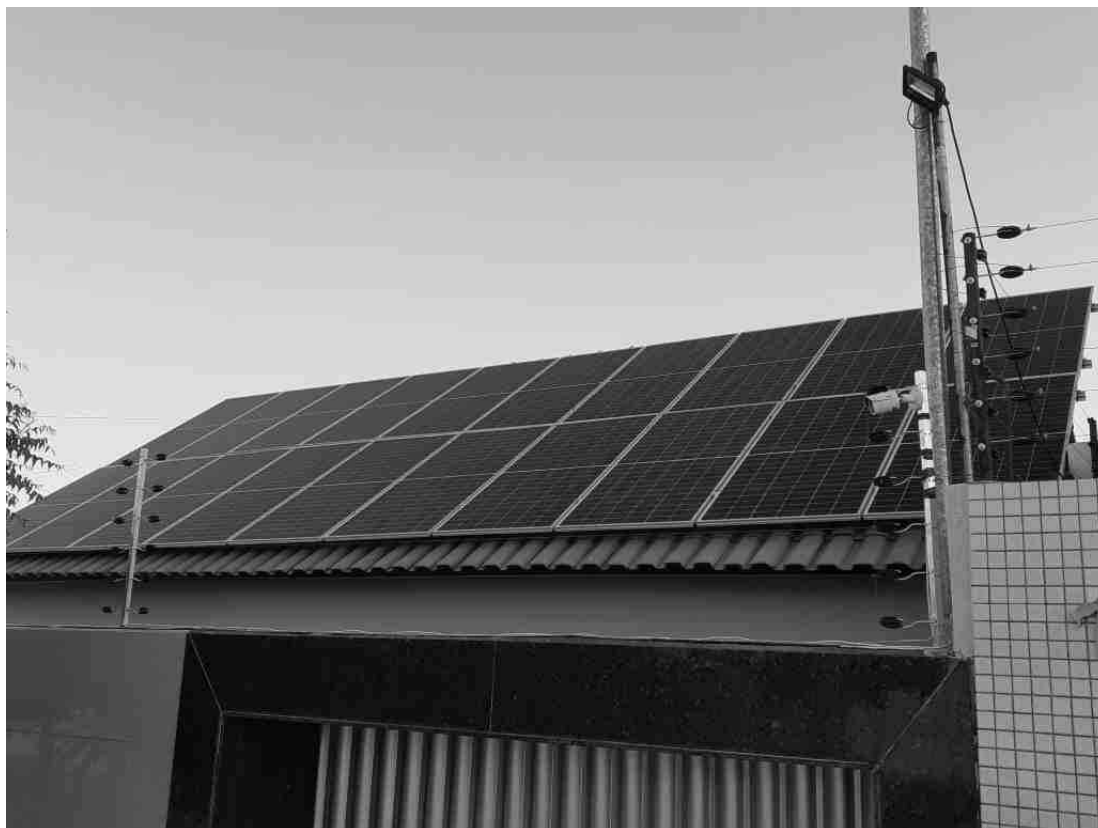
Figura 2.8 – Módulos fotovoltaicos instalados em telhado.
