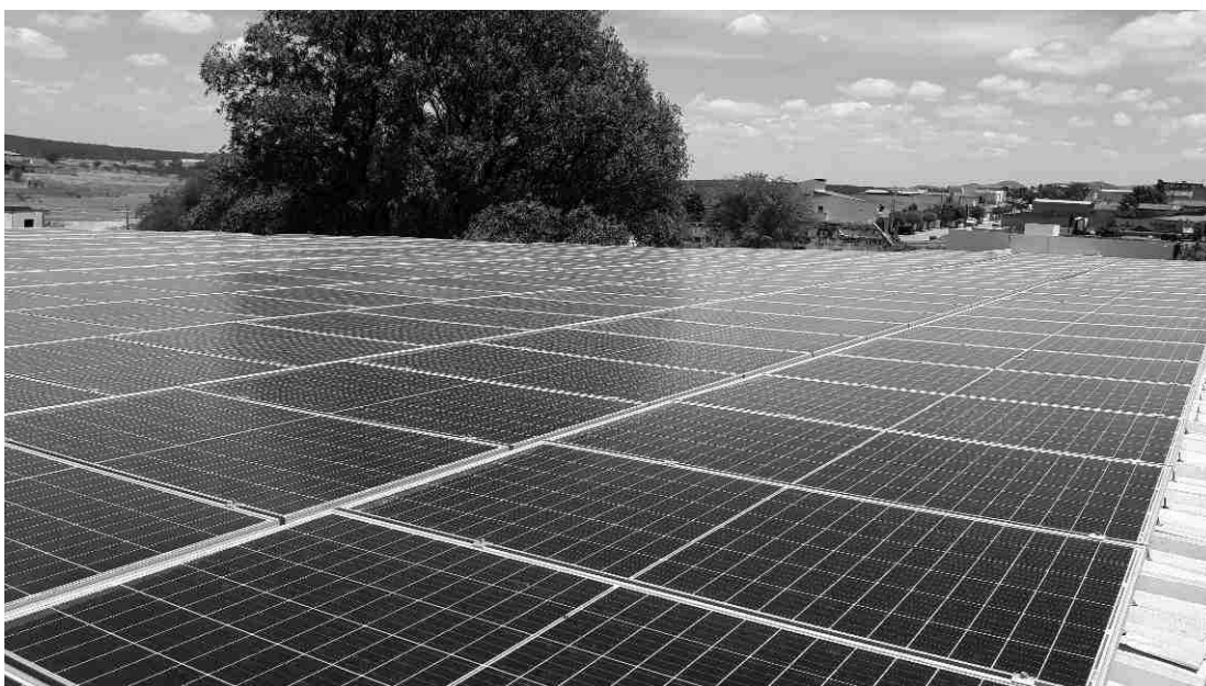
Figura 3.28 – Módulos fotovoltaicos instalados no telhado metálico.
