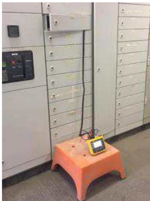
Figura 20 – Analisador de Qualidade de Energia
