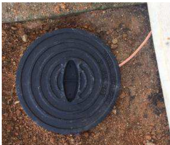
Figura 13 – Caixa de Aterramento
