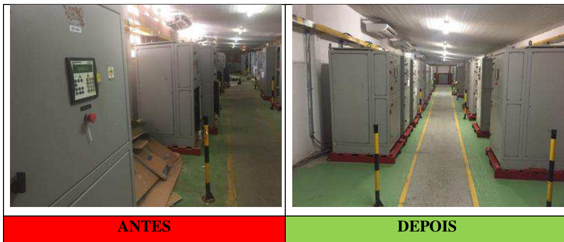
Figura 16 – Sala de Retificadores MTA
