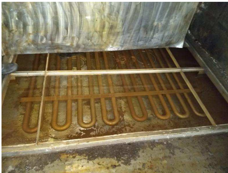
Figura 26 - Tubulação da máquina de condicionamento de fio.
