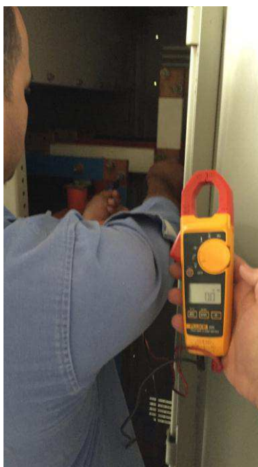
Figura 9 - Verificação de falta de tensão no quadro de força.
