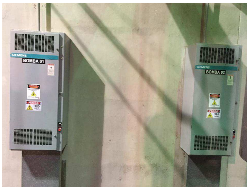
Figura 16 - Localização de instalação do painel.
