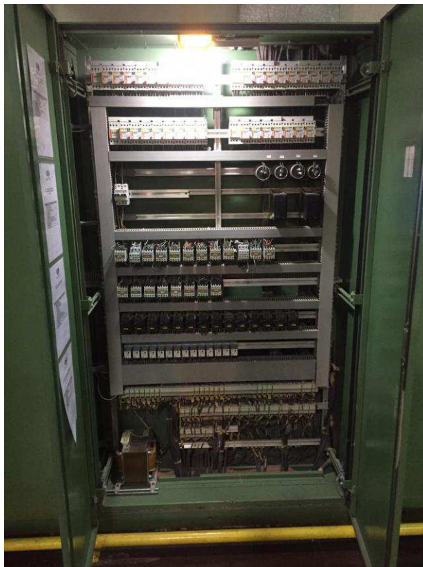
Figura 23 - Iluminação deficitária de painel.
