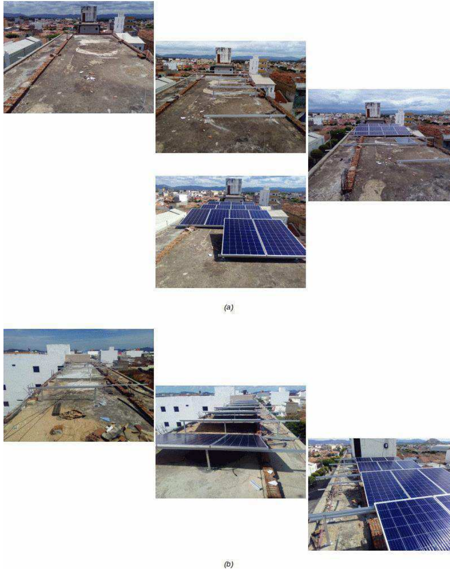
Figura 3.7: Registro da Evolução da Execução de um Sistema Fotovoltaico em Laje, Centro, Patos-PB, (a) Lado Norte (b) Lado Sul
