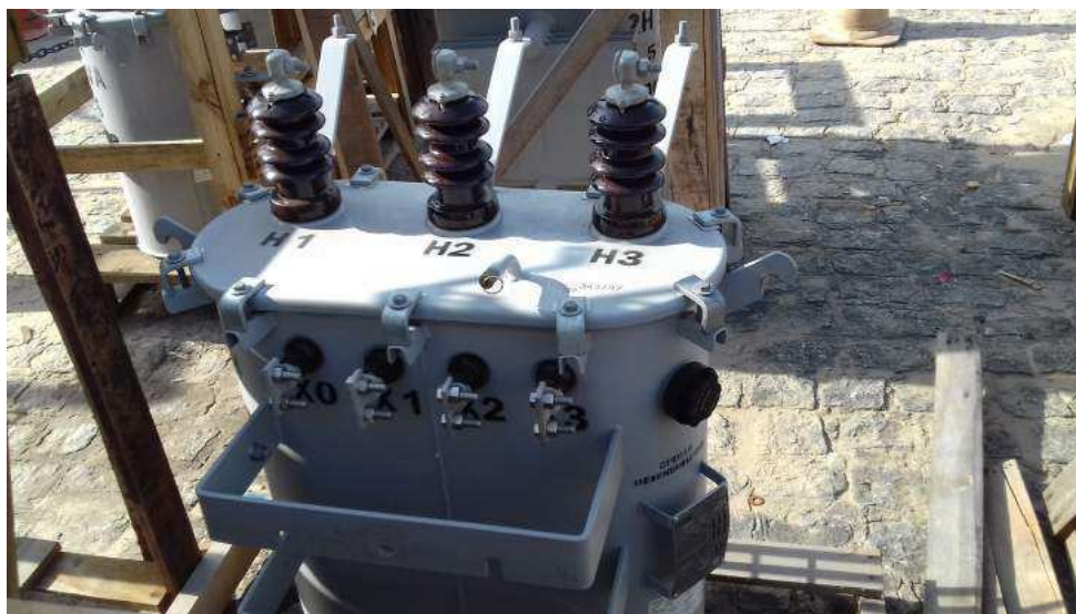
Figura 16 – Transformador de distribuição, terminais primários e secundários
