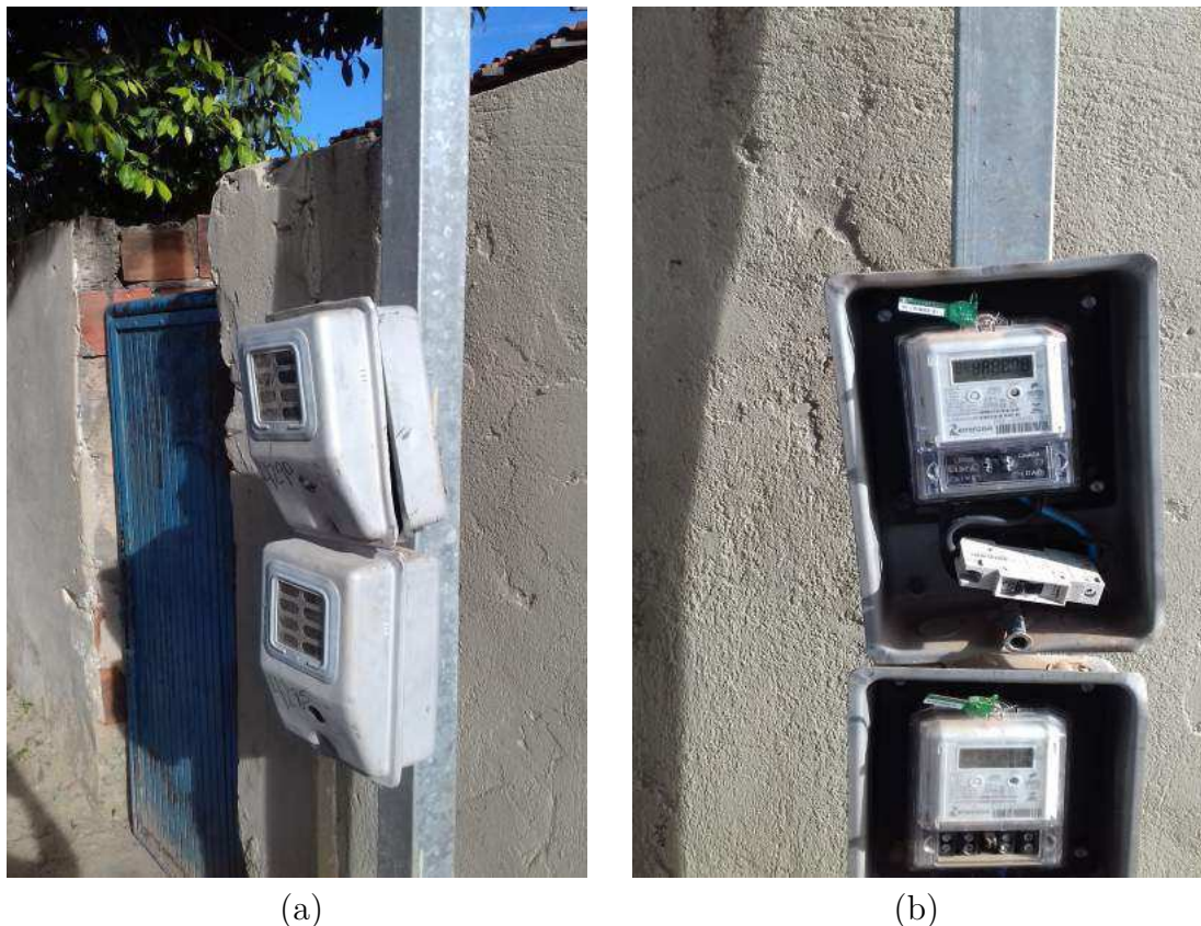
Figura 24 – (a) Caixa blindada violada pelo cliente (b) Cliente auto religado
