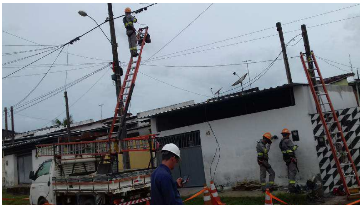
Figura 9 – Blindagem de circuito realizada na cidade de João Pessoa PB
