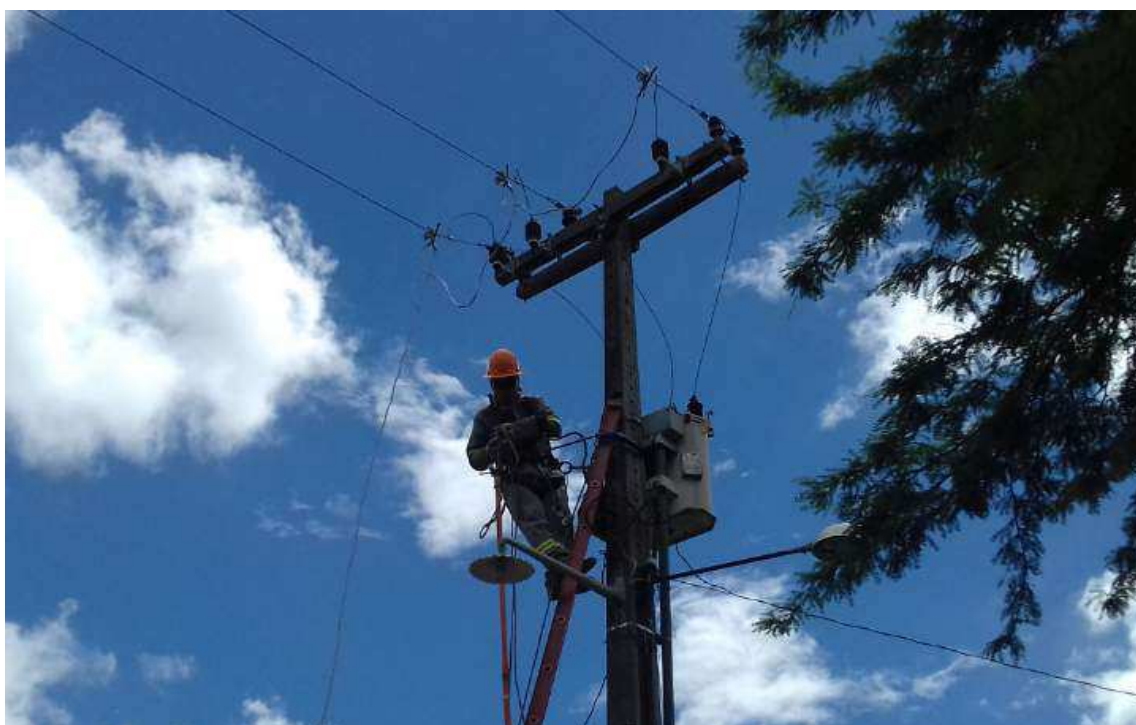
Figura 8 – Blindagem de trafo realizada na cidade de Caldas Brandão PB
