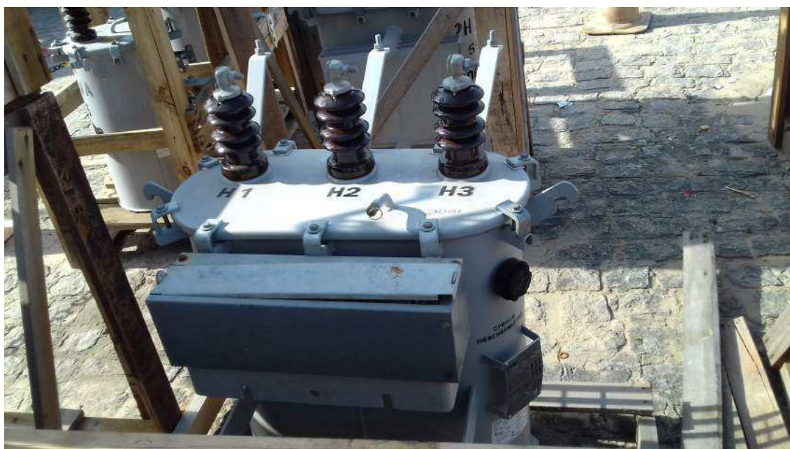
Figura 17 – Local de instalação da murfla na blindagem de trafo
