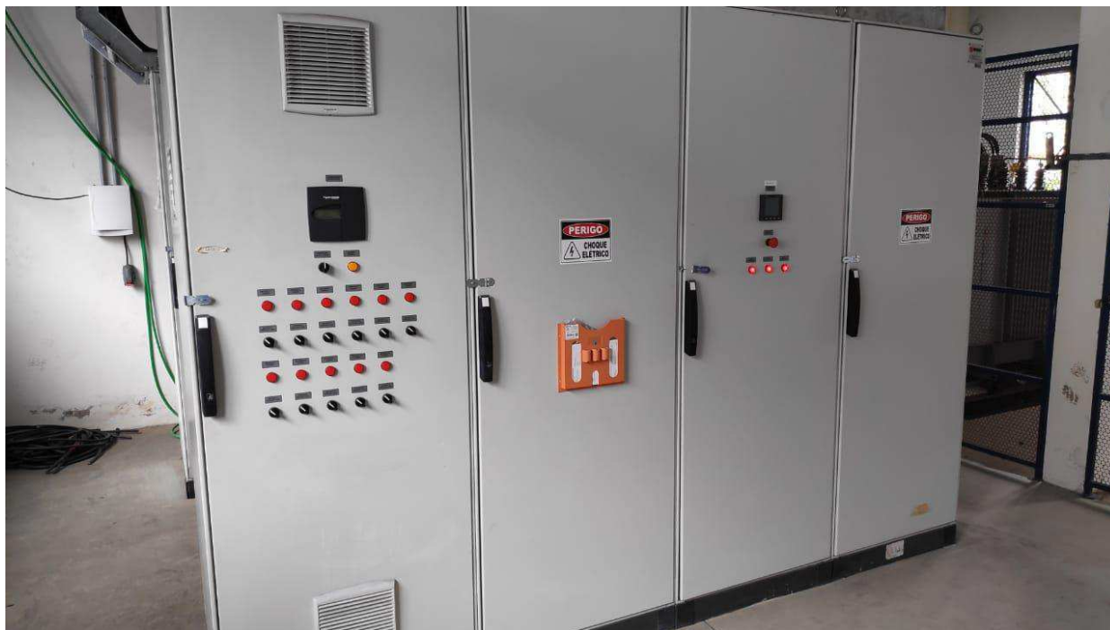
Figura 5 – Quadro geral de baixa tensão da unidade 05 (fechado)
