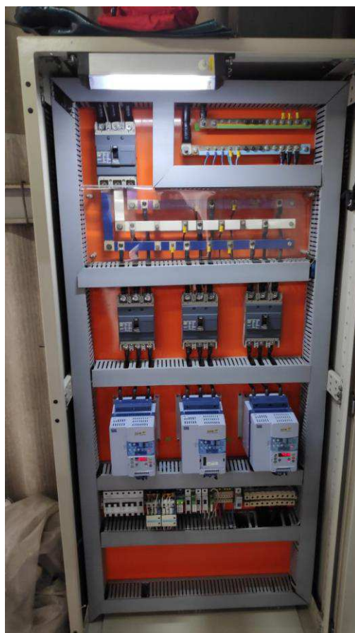
Figura 6 – Quadro geral de baixa tensão da unidade 05 (aberto)
