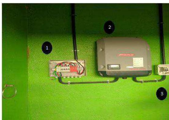
Figura 10: Conexão do inversor (2) com a string box CC (1) e string box CA (3).
