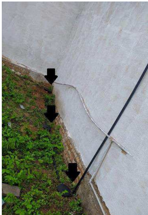
Figura 9: Fotografia da malha de aterramento do inversor.
