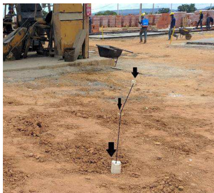
Figura 11: Malha de aterramento da betoneira.
