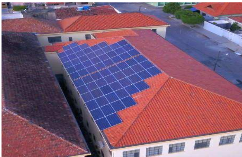
Figura 12 – Vista panorâmica das placas solares
