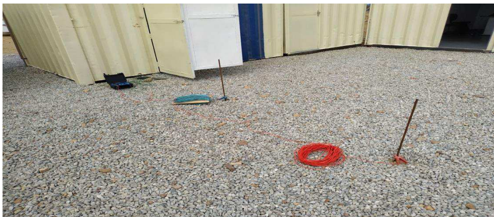
Figura 23 – Medição das resistências de aterramento.
