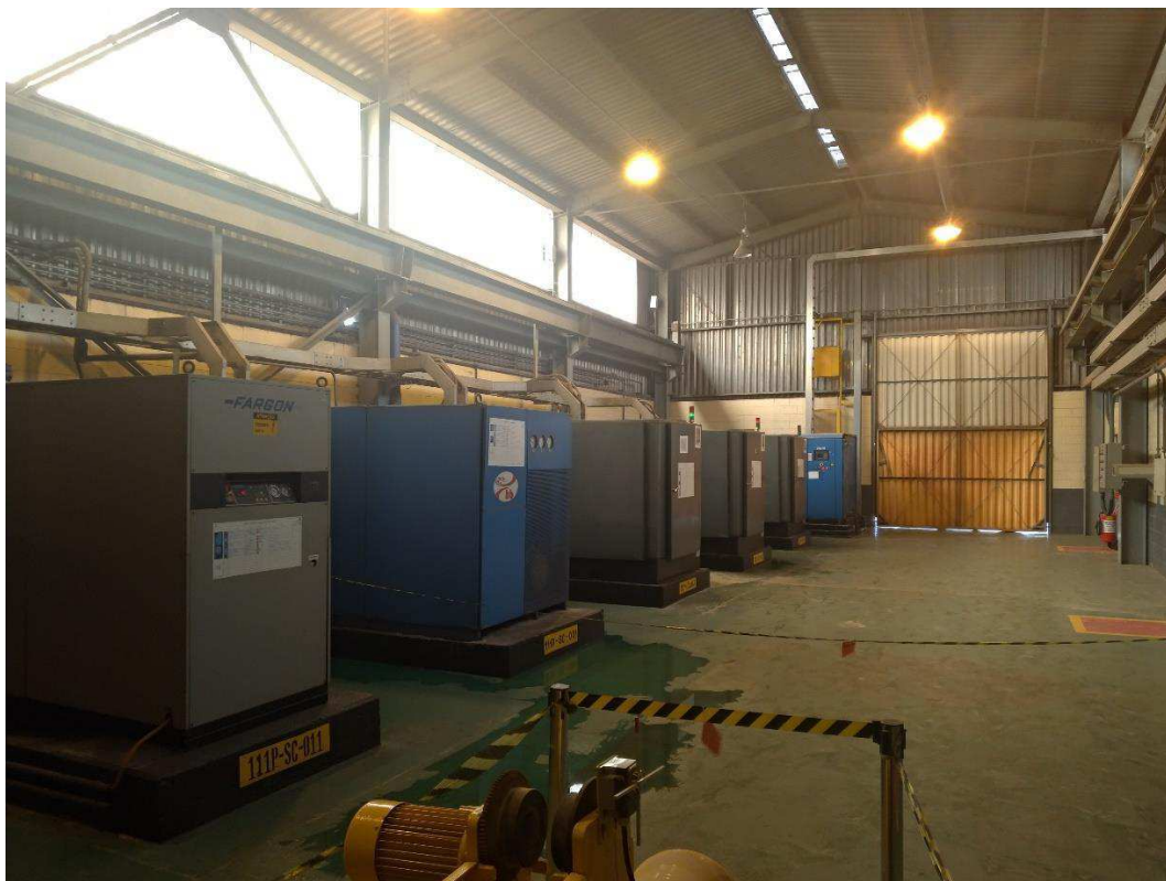
Figura 22: Sala de compressores.
