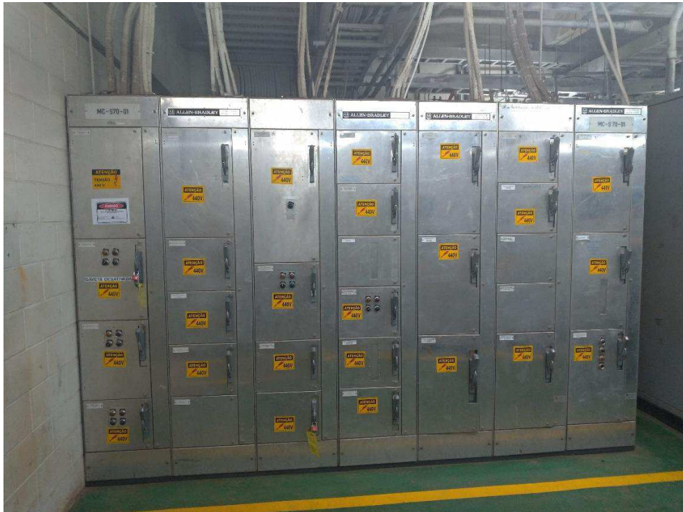
Figura 18: Cento de controle de motores (CCM) subestação S70.
