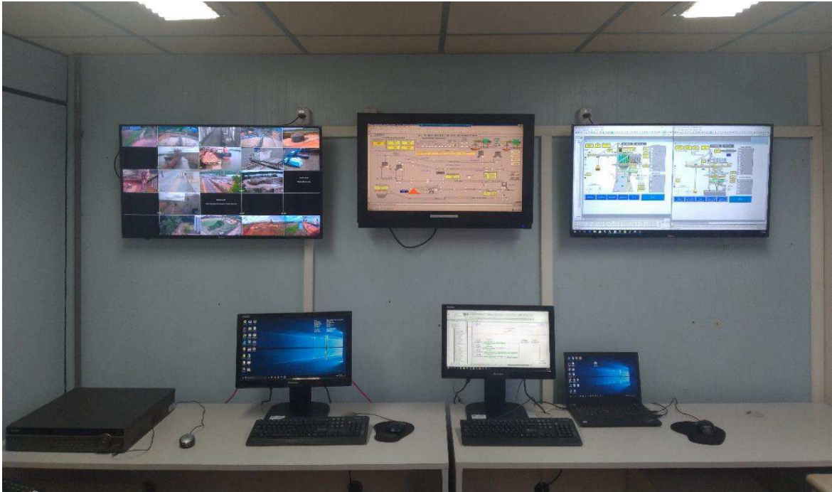
Figura 16: Sala de automação Porto.
