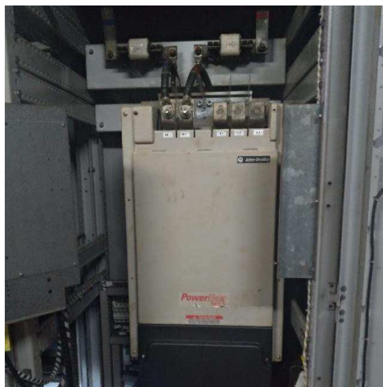
Figura 25: Inversor de frequência
