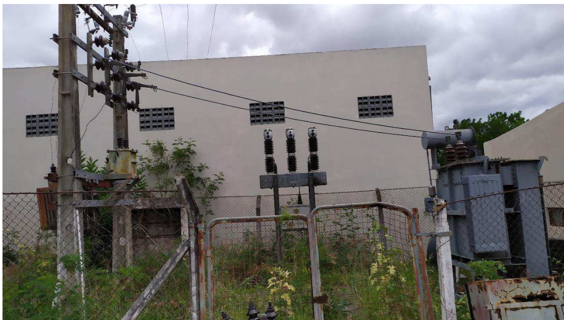
Figura 23 - Subestação do LAT.
