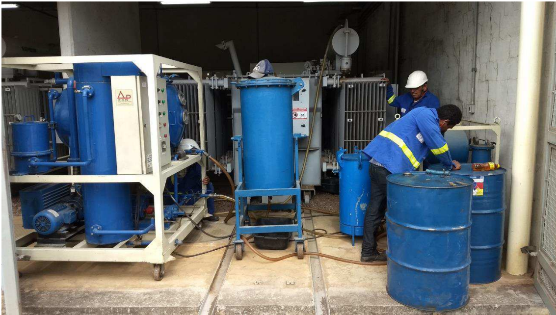
Figura 19 - Atividade de tratamento de óleo do transformador.
