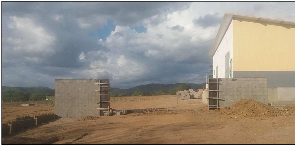
FIGURA 5 - ENTRADA DA SUBESTAÇÃO EM PALMEIRA DOS ÍNDIOS – AL.
