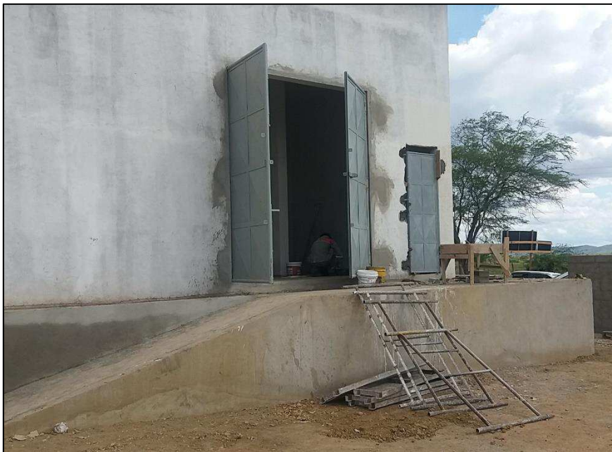
FIGURA 3 - SALA DE COMANDO EM PALMEIRA DOS ÍNDIOS – AL.
