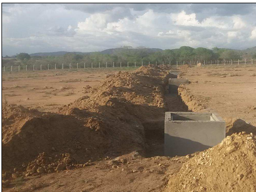
FIGURA 4 - CAIXAS DE PASSAGEM EM PALMEIRA DOS ÍNDIOS – AL.
