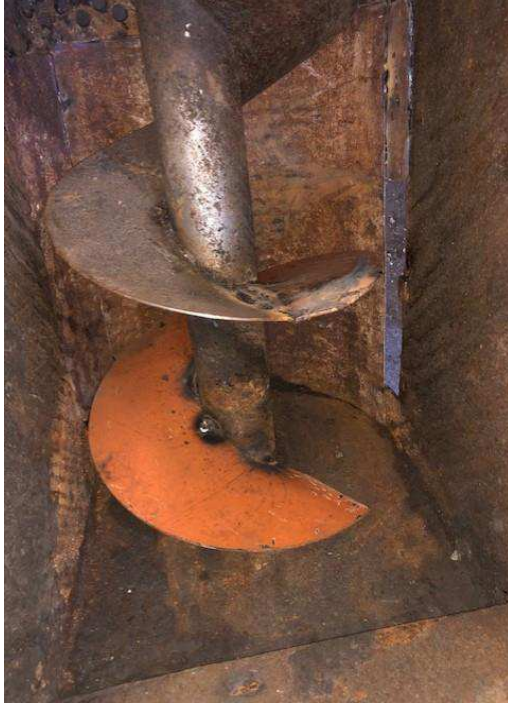
Figura 25: Parte do helicoide substituído. Fonte: Autoria própria
