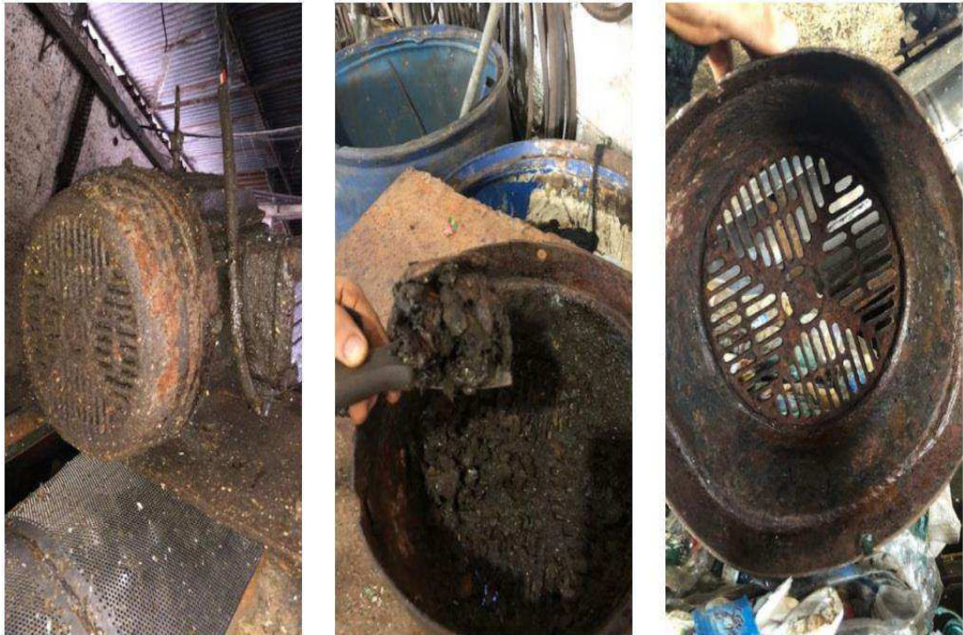
Figura 36: Motor da lavadora sujo, limpeza da proteção da ventoinha e a proteção após a limpeza Fonte: autoria própria
