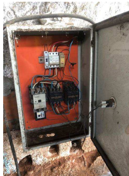
Figura 31: Interior do quadro elétrico Fonte: Autoria própria
