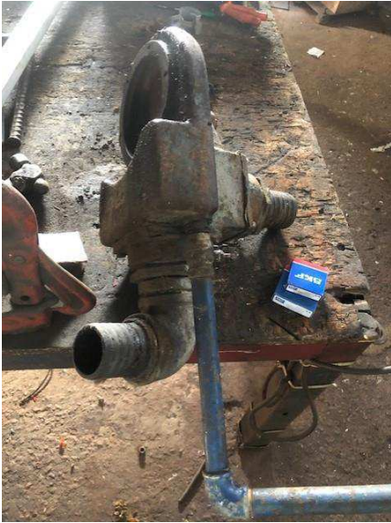
Figura 41: Bomba d'água na oficina manutenção Fonte: Autoria própria
