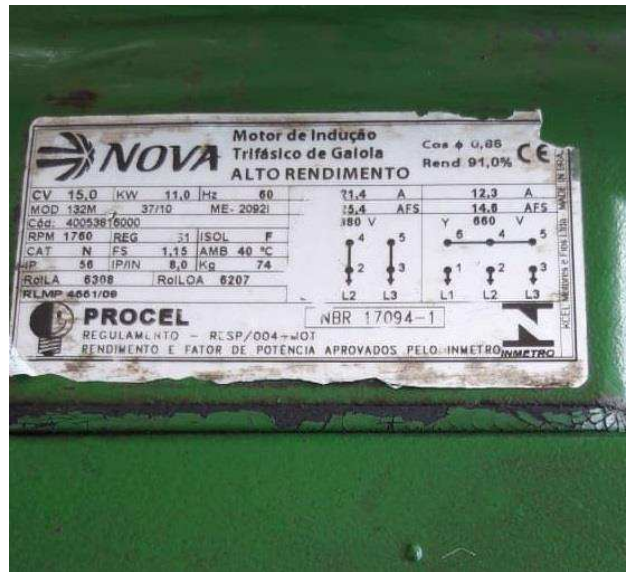
Figura 55: Dados de placa do motor elétrico do compressor Fonte: Autoria própria
