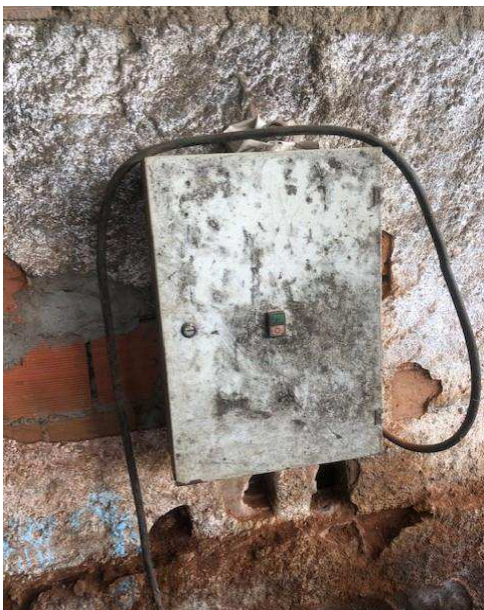
Figura 30: Quadro elétrico desativado Fonte: Autoria própria
