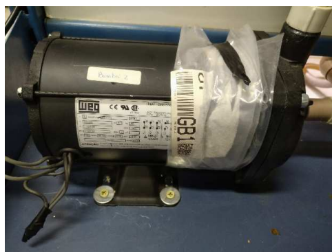
Figura 17 – Bomba com ventoinha bloqueada
