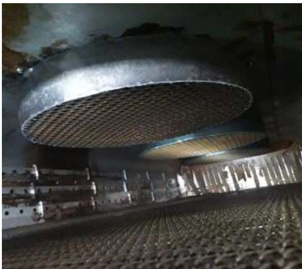
Figura 6 – Proteção no forno da empacotadora
