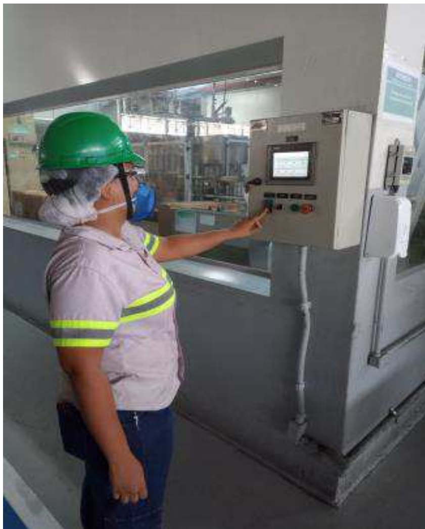
Figura 5 – Operadora no desligamento de equipamentos.
