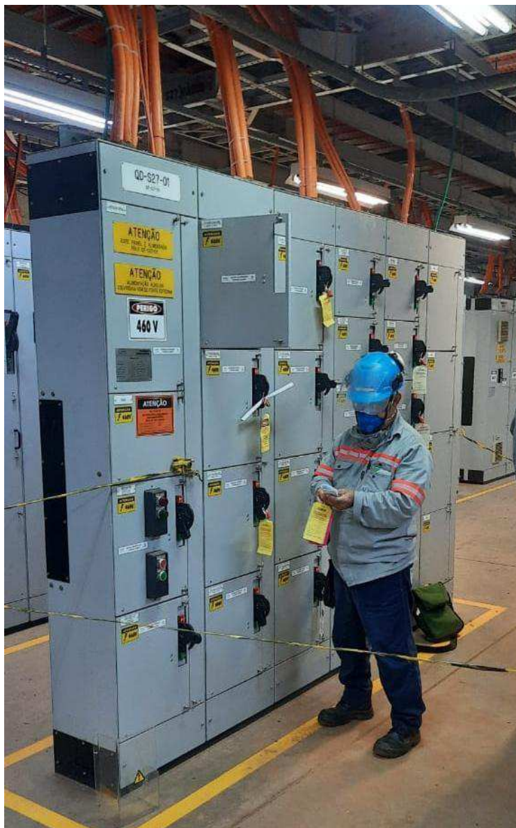
Figura 17 – EBTV para intervenção da gaveta na subestação.
