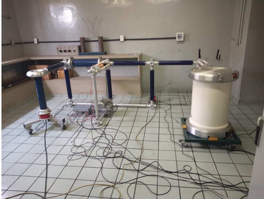
Figura 13: Montagem do Kit de alta tensão - Impulso
