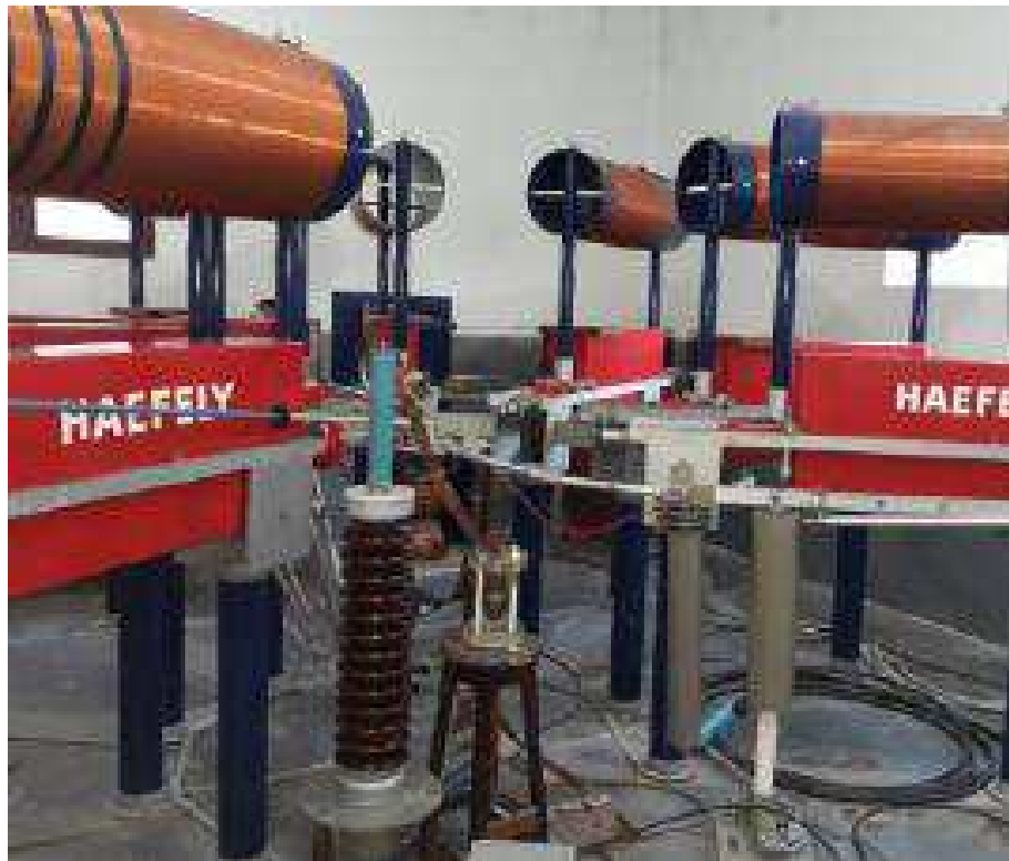
Figura 5: Sala do Gerador de Impulso de Corrente.
