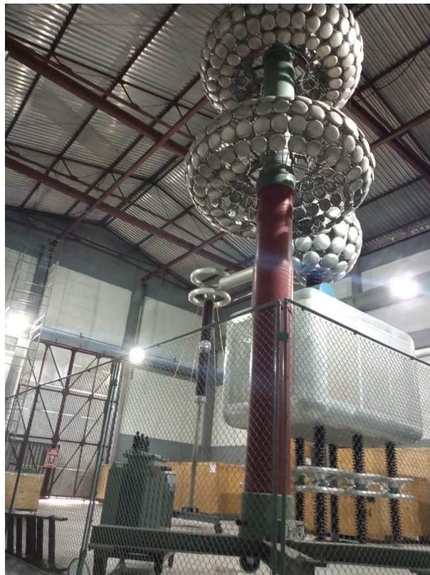
Figura 2: Salão de Alta Tensão.
