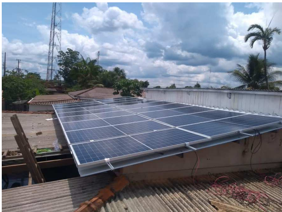
Figura 14 – Painel instalado na unidade consumidora
