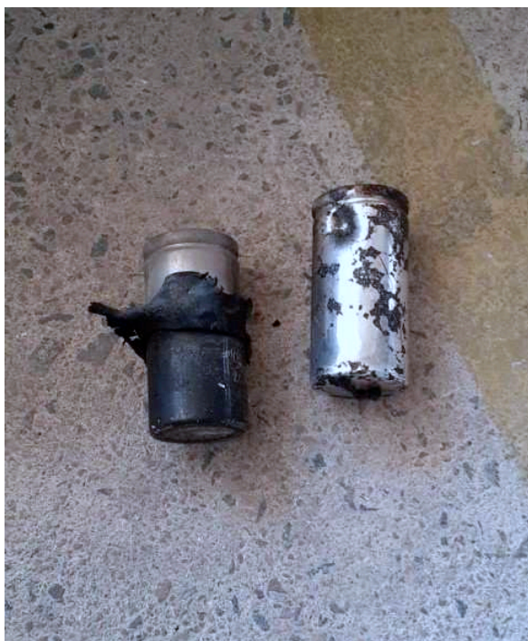
Figura 3.16 – Registro fotográfico de capacitores do inversor de 60 kW estourados.
