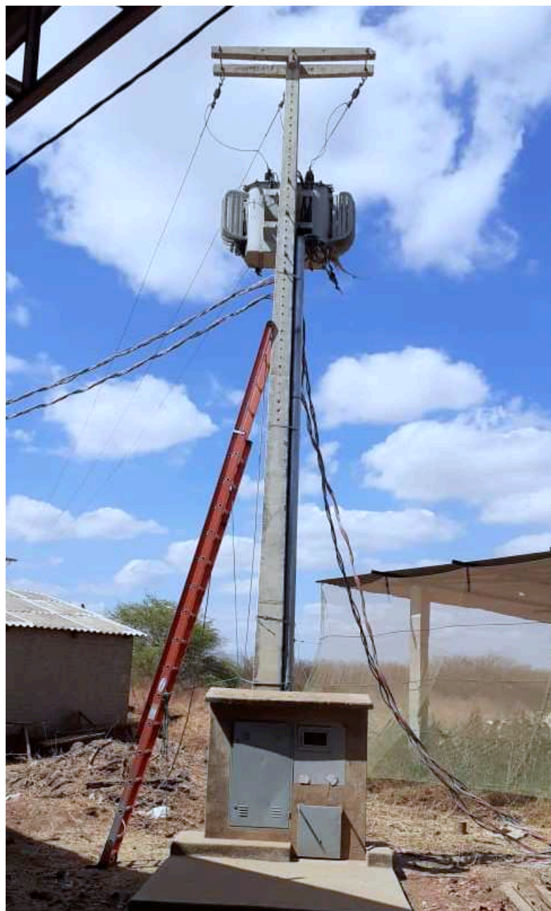
Figura 3.11 – Registro fotográfico do ponto de conexão dos cabos de chegada provenientes da usina solar no ponto de conexão à rede de distribuição da Energisa.
