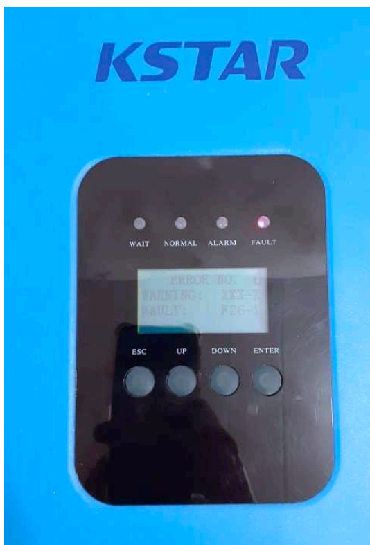
Figura 3.21 – Registro fotográfico da falha F26 no inversor da KSTAR.
