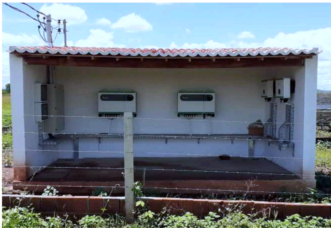
Figura 3.7 – Registro fotográfico do abrigo dos inversores.
