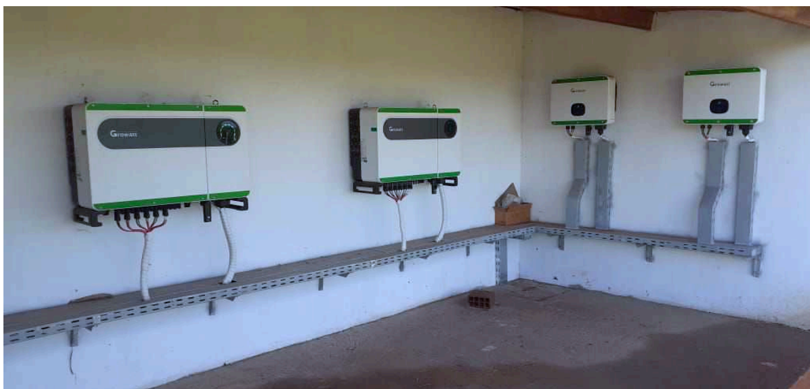
Figura 3.8 – Registro fotográfico dos inversores de 75\text{ kW} e 20\text{ kW} em pleno funcionamento.
