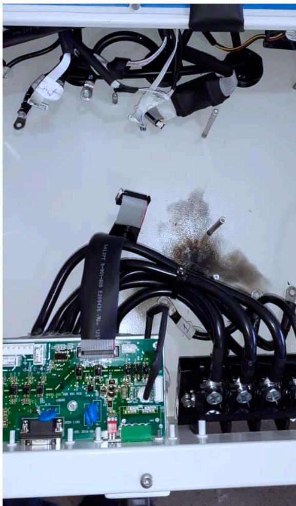
Figura 3.19 – Registro fotográfico da base da placa queimada no inversor.
