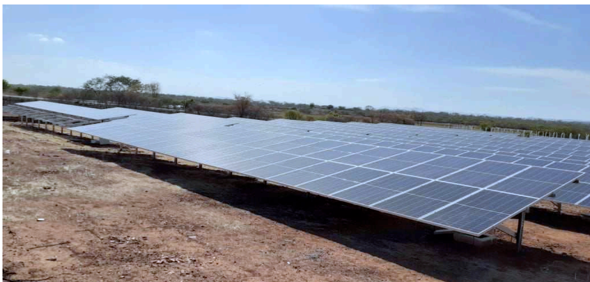
Figura 3.6 – Registro fotográfico dos painéis fotovoltaicos fixados nas estruturas de alumínio.
