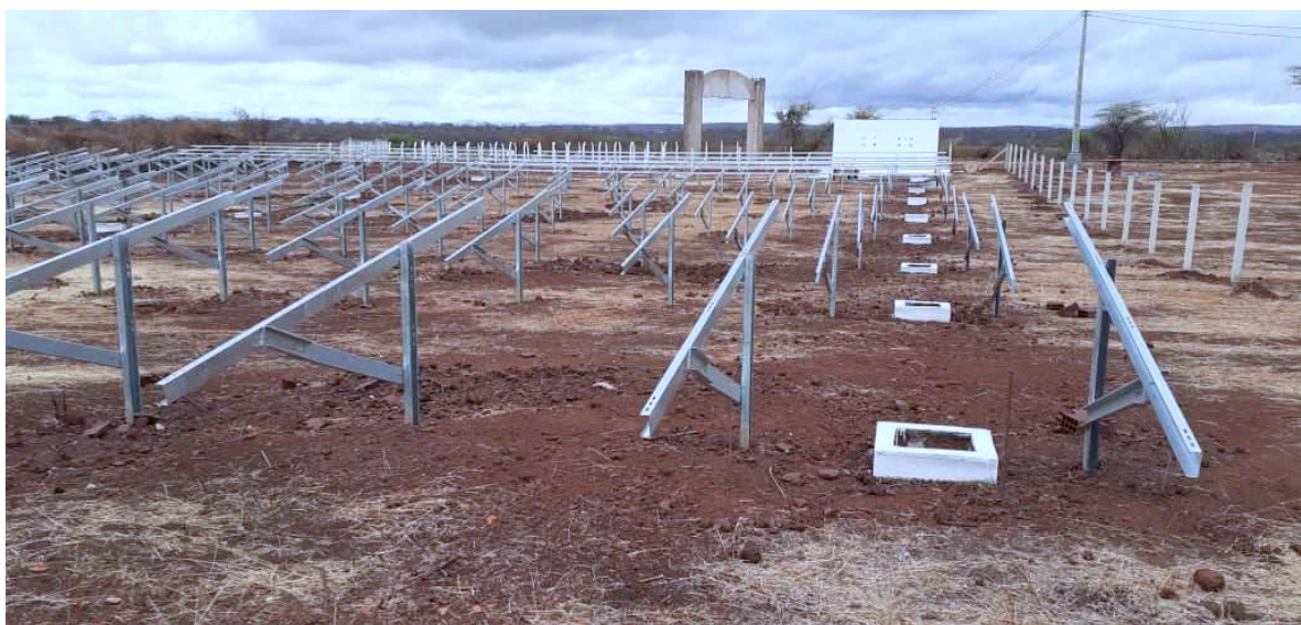
Figura 3.4 – Registro fotográfico das estruturas de fixação dos painéis fotovoltaicos.
