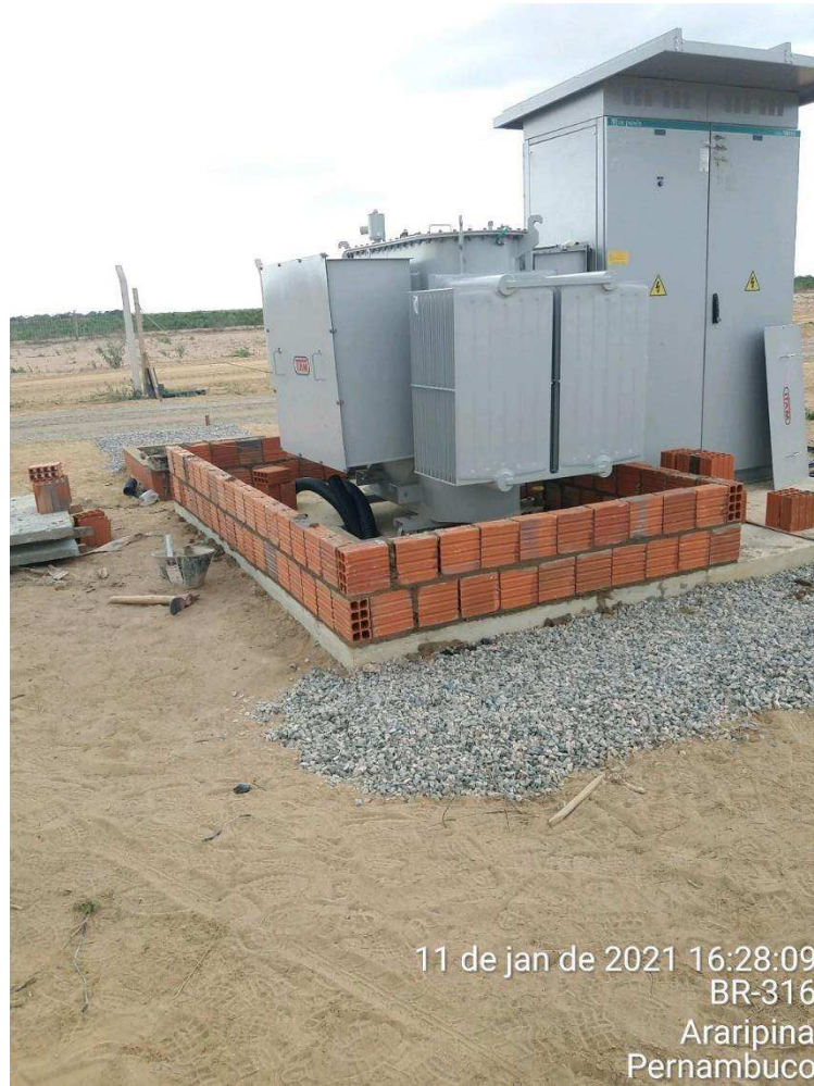
Figura 7: Transformador 900 kVA acoplado ao QGBT.
