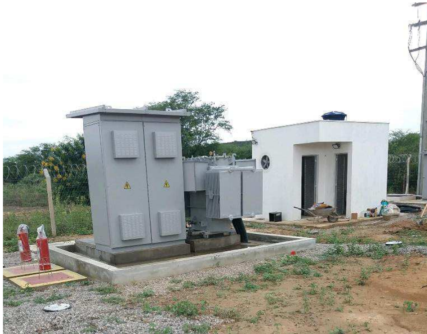
Figura 26: Disposição dos extintores próximos ao transformador acoplado ao QGBT.
