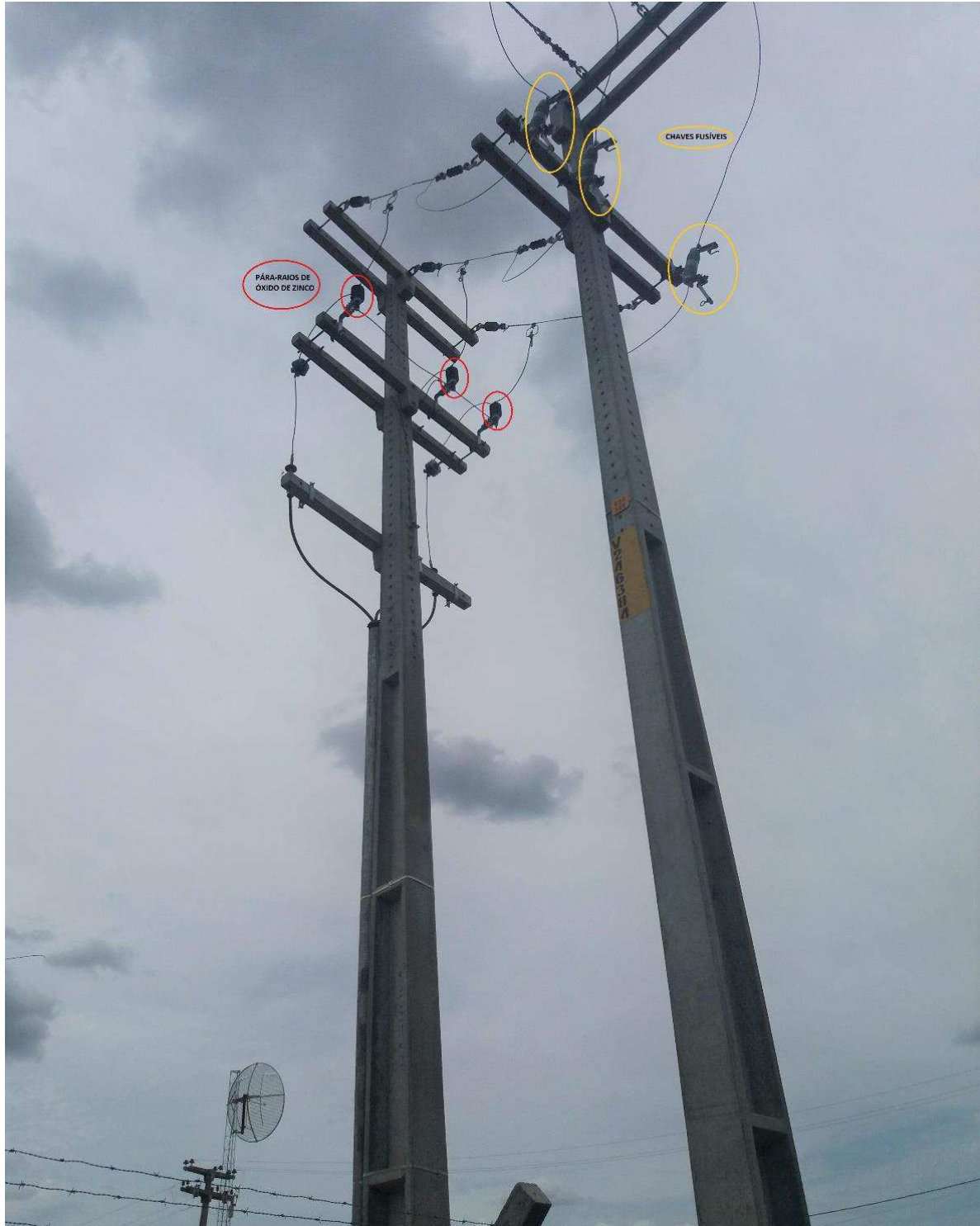
Figura 18: Ponto de entrega da outra usina de mesmo porte, mas como alocação dos equipamentos de proteção voltados para fora da usina.
