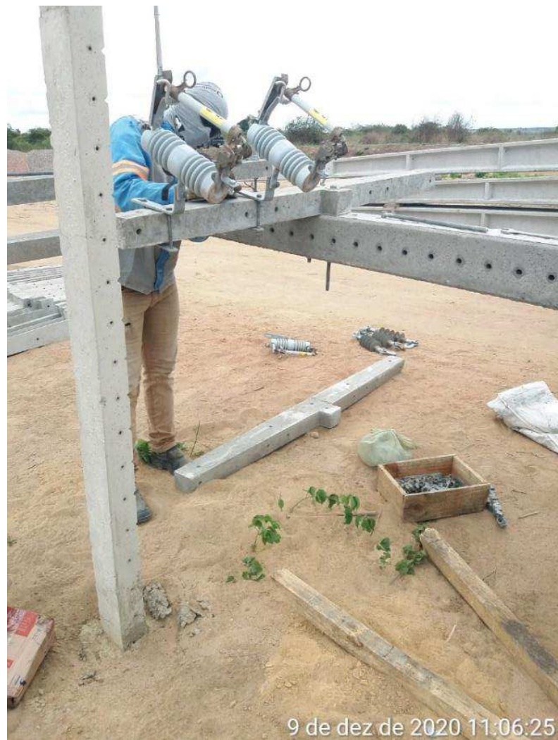
Figura 19: Instalação das chaves fusíveis no poste da usina.
