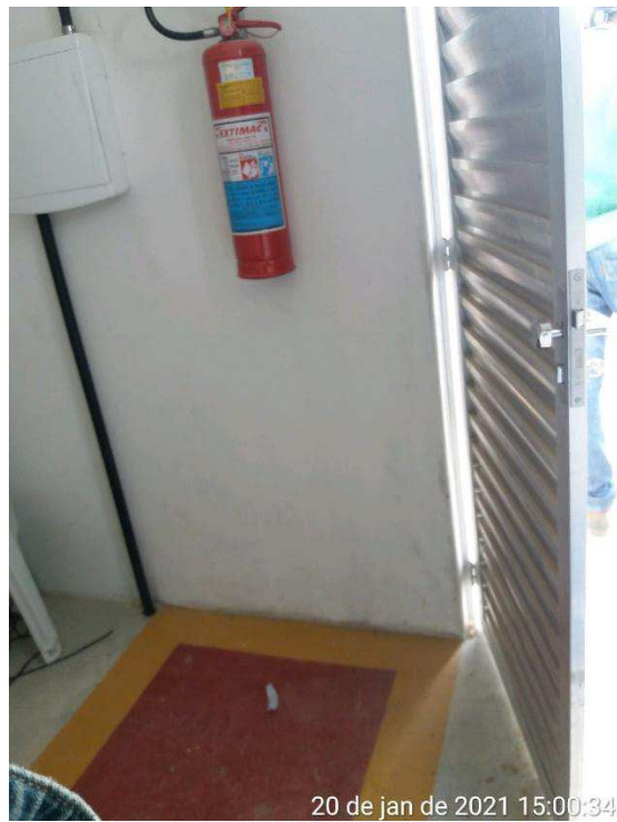
Figura 25: Disposição do extintor na sala de controle.
