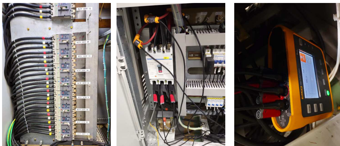
Figura 30 – Analisador de Qualidade de Energia - Fluke
