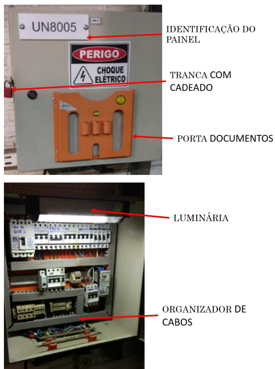
Figura 50 – Melhoria nos Quadros Elétricos - Depois
