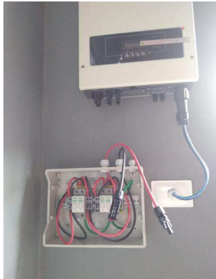
Figura 21 – Inversor e quadro string box
