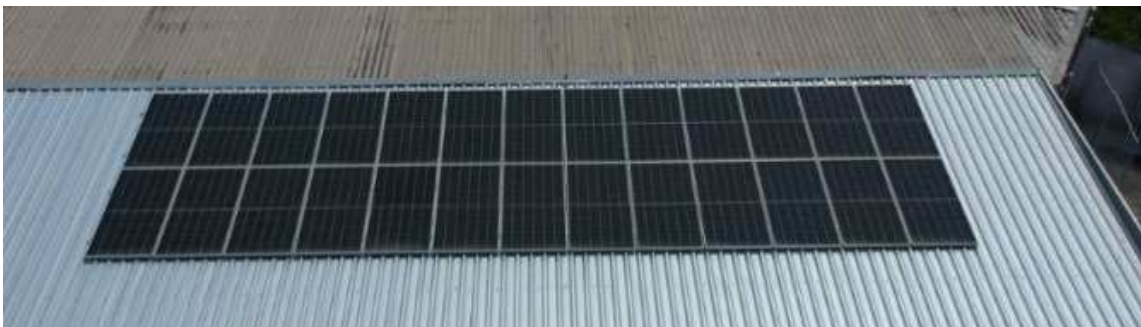
Figura 24: Placas fotovoltaicas instaladas.
