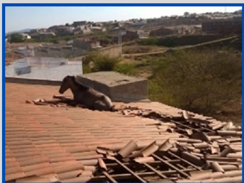
Cavalo foi parar em cima de telhado de casa após 'errar' caminho em Cajazeiras, na Paraíba (Foto: Cicero Segundo / Corpo de Bombeiros)
