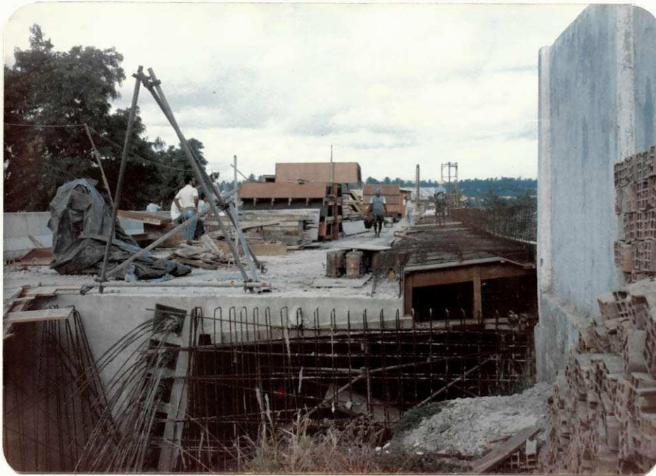
Laje superior concretada. Detalhe dos cabos de aço da protensão após serem tracionados, através de macacos hidráulicos.
