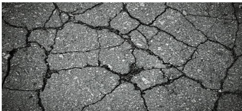
Figura 7- Demonstração de fendas no pavimento.
