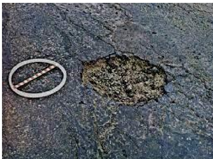
Figura 12- Demonstração de panela no pavimento.
