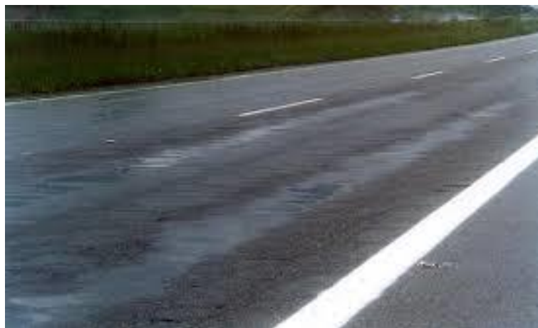
Figura 8- Demonstração de Afundamento no pavimento.
