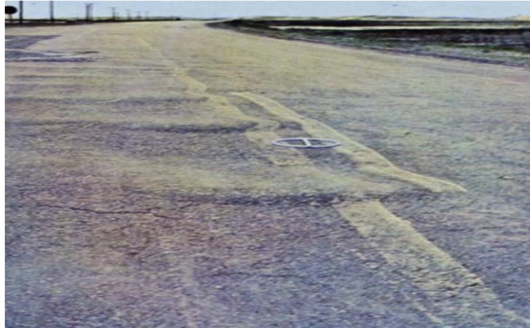
Figura 9- Demonstração de corrugações no pavimento.
