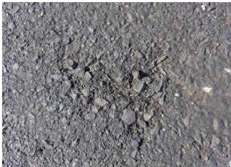
Figura 11- Demonstração de Desgaste no pavimento.
