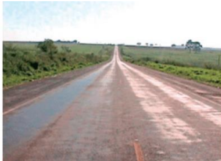
Figura 10- Demonstração de exsudação no pavimento.
